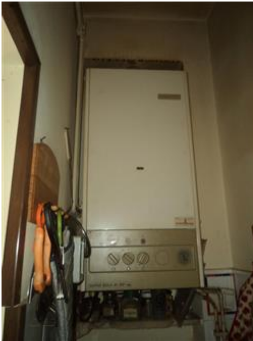
Interno dell'appartamento, particolare caldaia alimentata a metano.
