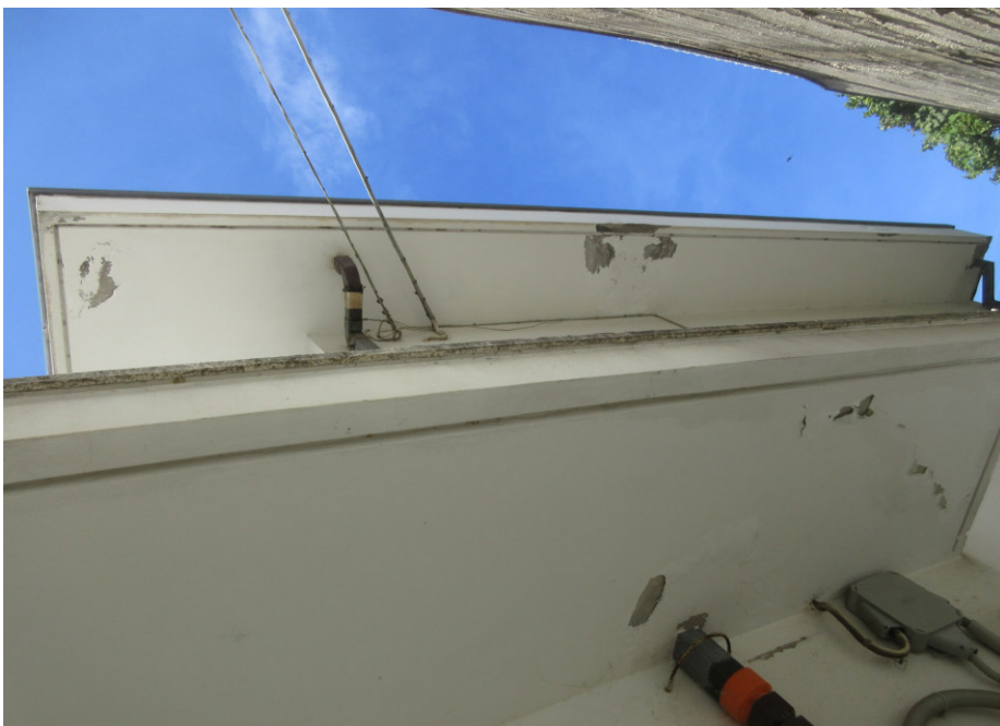
foto 28 Condizione degrado cornice
