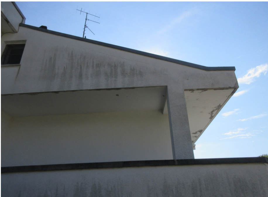
foto 27 Condizione degrado cornice
