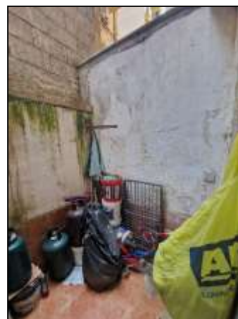
All. 10 – Foto 11 pozzo luce
