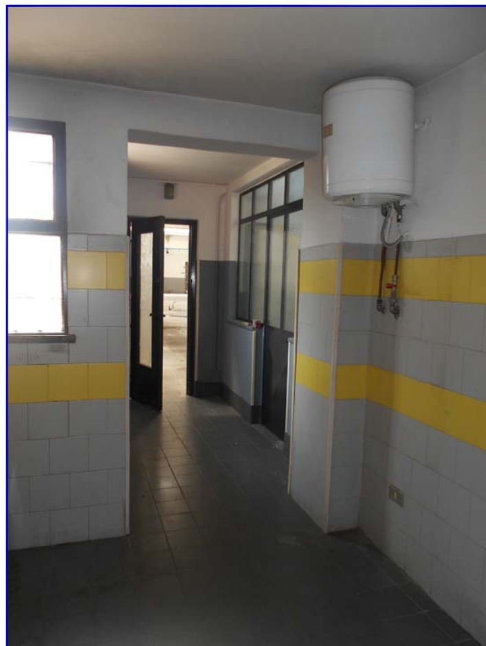
Foto 15: Bagni ubicati nella porzione di fabbricato edificato abusivamente a confine e da demolire.
