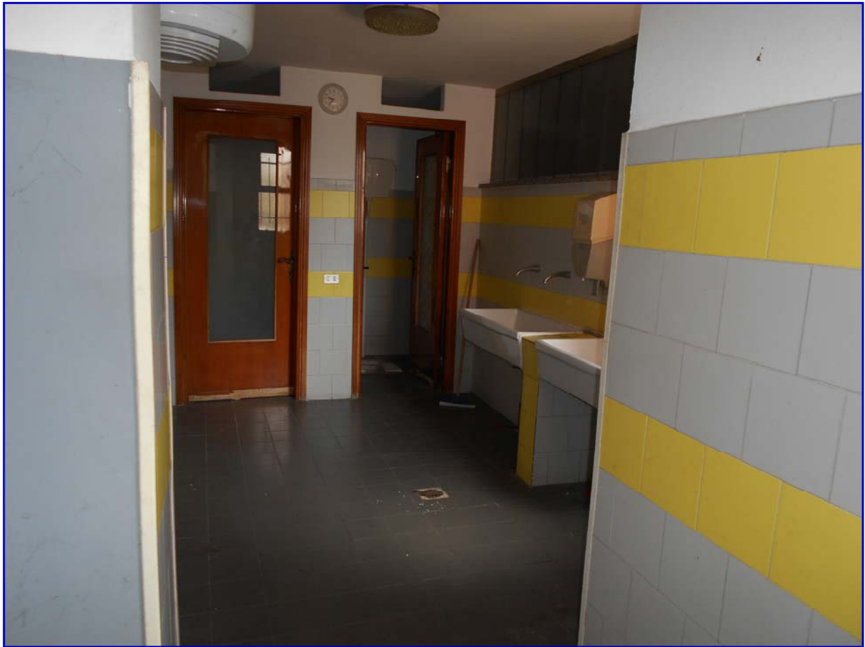
Foto 14: Bagni ubicati nella porzione di fabbricato edificato abusivamente a confine e da demolire.
