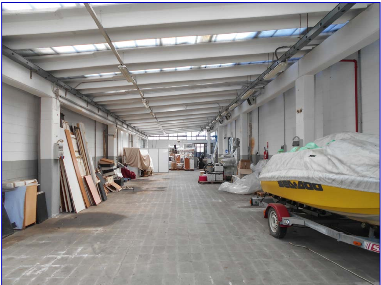
Foto 13: Vista interna del fabbricato edificato abusivamente a confine e da demolire.
