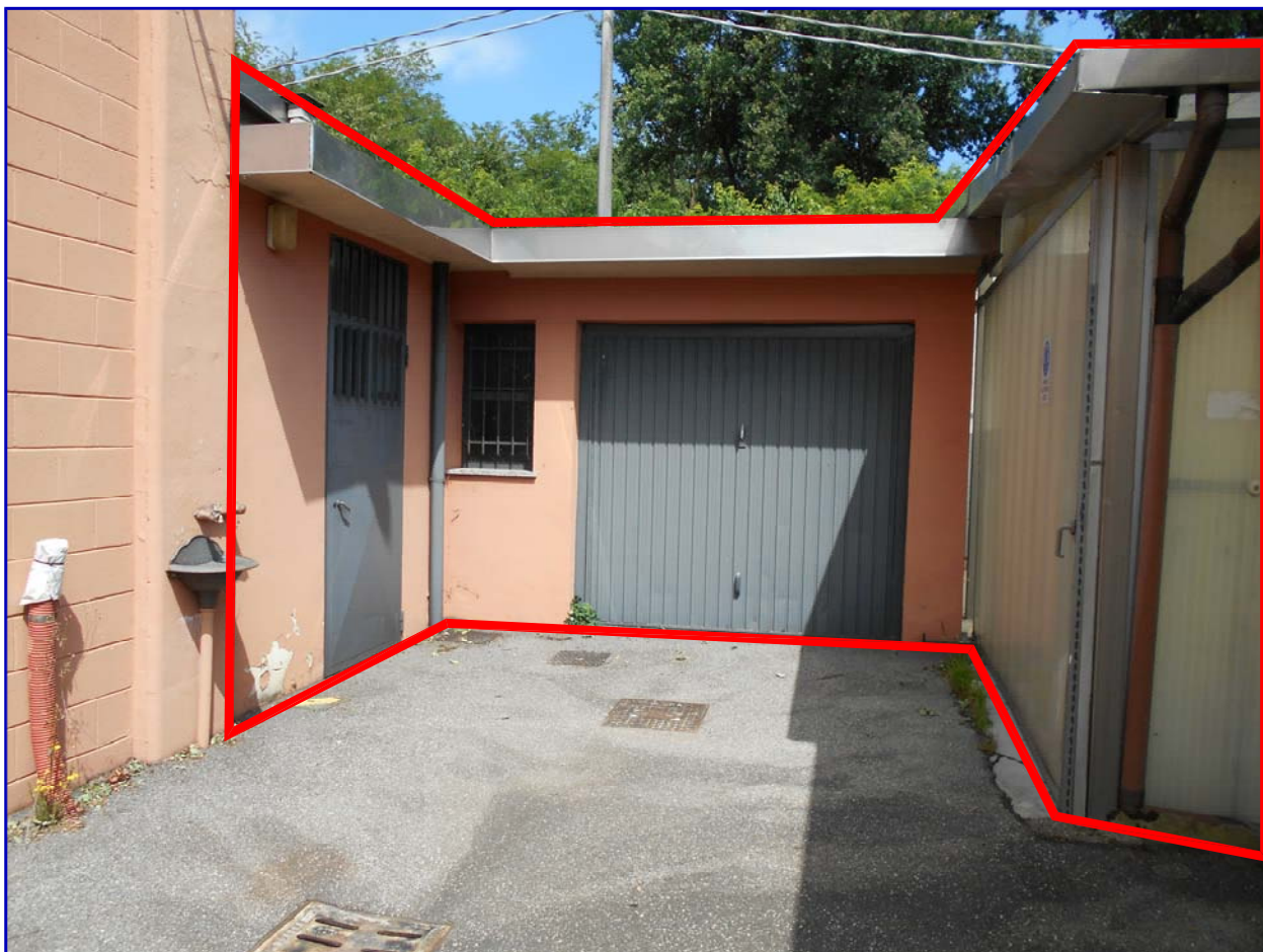
Foto 77: Box e porzione di fabbricato costruiti a confine, da demolire.
