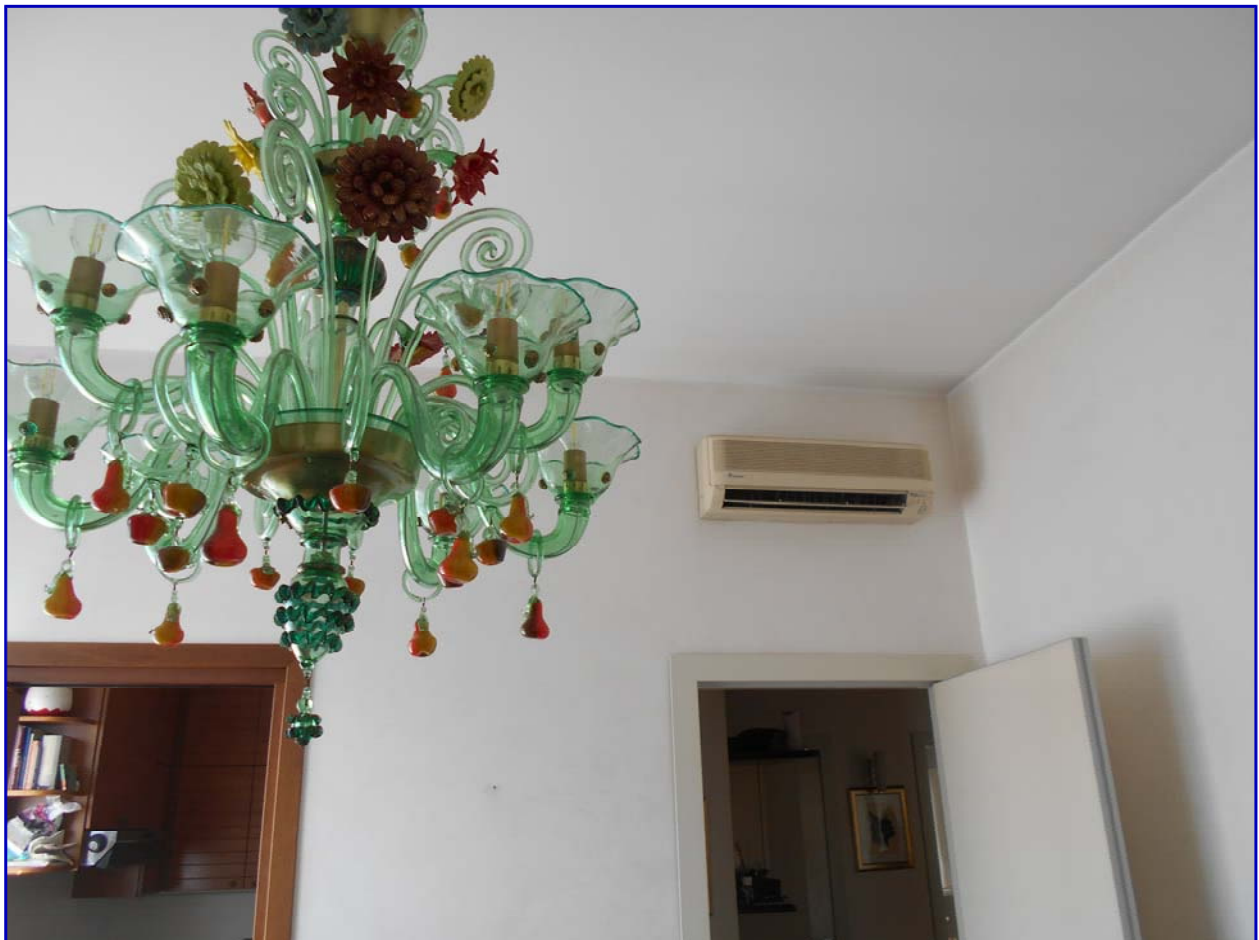
Foto 23: CORPO A - Sala da pranzo. Particolare dello split per aria condizionata.
