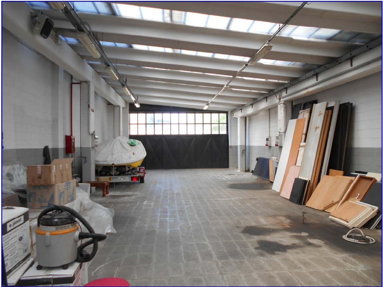
Foto 12: Vista interna del fabbricato edificato abusivamente a confine e da demolire.
