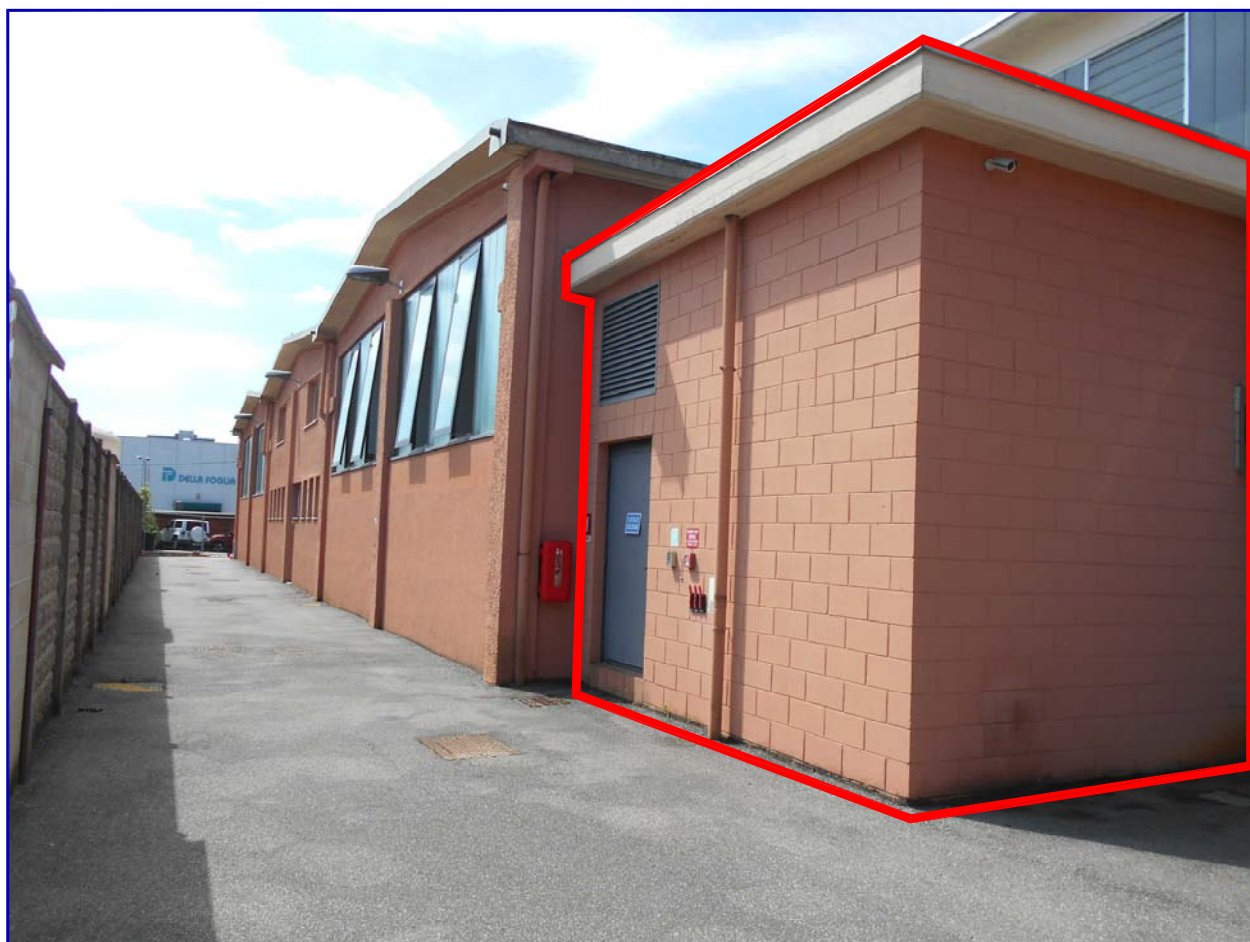
Foto 75: Locale centrale termica per il quale occorre prevedere opere di regolarizzazione per il rispetto delle distanze dal confine ed area scoperta comune per la quale occorre prevedere la rimozione del manto d'asfalto ed il rifacimento della pavimentazione con la posa di autobloccanti.
