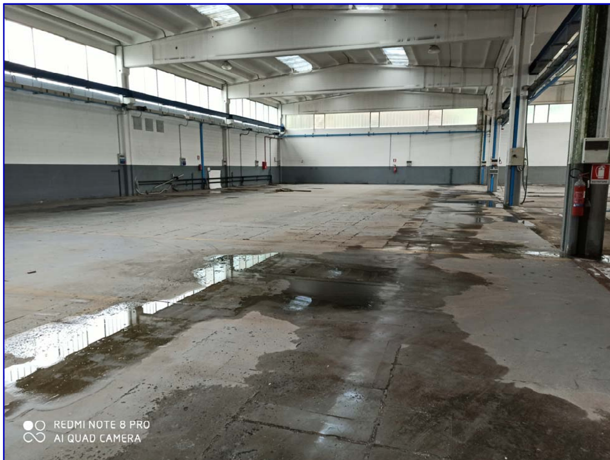
Foto 24: Fenomeni di allagamento causati dalle infiltrazioni d'acqua piovana provenienti dal tetto.
