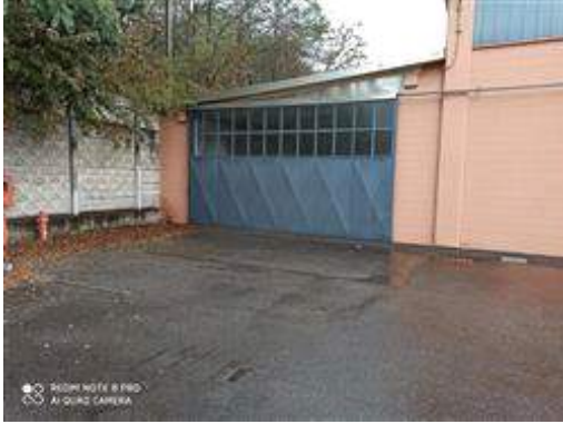
Corpo di fabbrica a confine abusivo, non regolarizzabile e da demolire - Vista esterna
