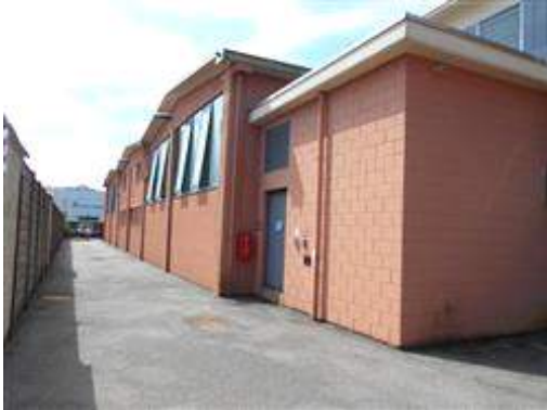
Locale Centrale termica e pavimentazione in asfalto.
