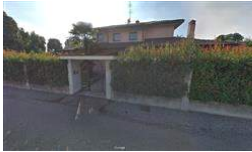
Recinzione su confine Est di altezza maggiore di ml. 2,00 previsti da R.E. Comunale vigente
