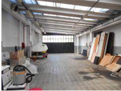
Corpo di fabbrica a confine abusivo, non regolarizzabile e da demolire - Vista interna
