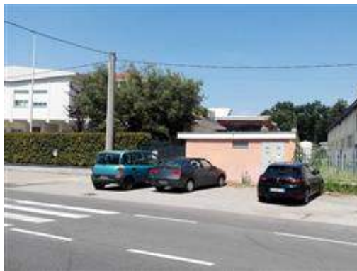
Cabina di trasformazione ENEL su via Colombo.
