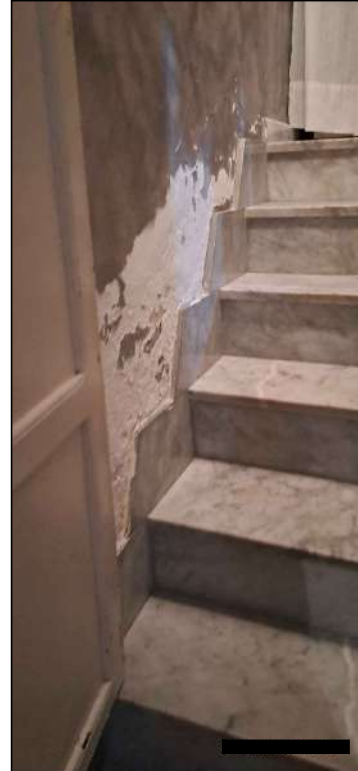
scaletta di collegamento dei due livelli del PT esfoliazione
