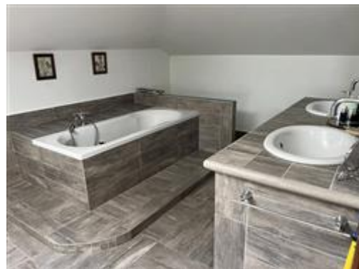
BAGNO REALIZZATO SENZA TITOLO E NON MANTENIBILE (piano sottotetto)
