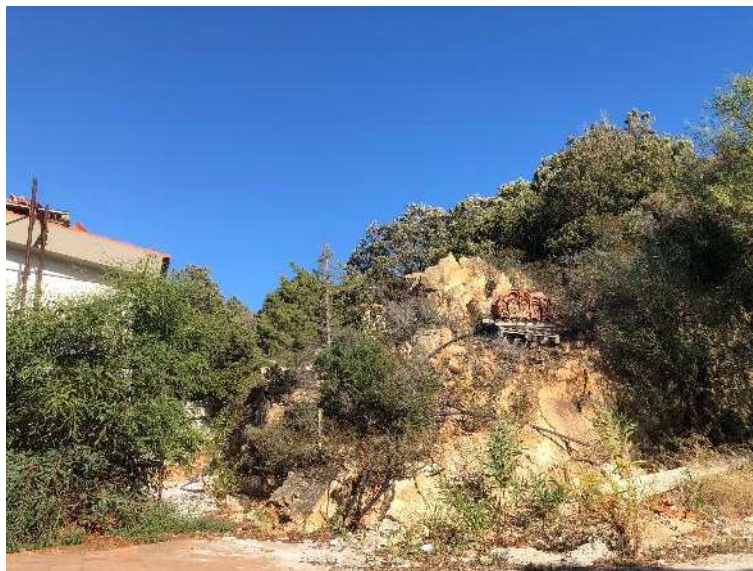
Immagine 09: Lo stato fatiscente della zona barbecue apprezzata lateralmente, rilevata dallo scrivente nell'anno 2019.
