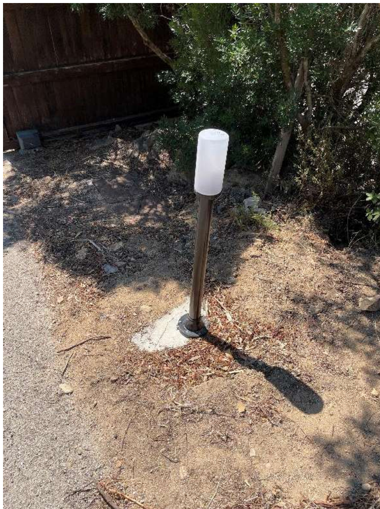
Immagine 04: Primo piano dei paletti di illuminazione presenti nella strada di accesso alla villa, rilevati dallo scrivente nel 2023.
