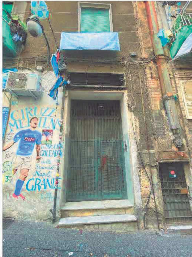
Foto 7 – Vista esterna: portone di ingresso fabbricato civ. n. 63 di Via Emanuele De Deo
