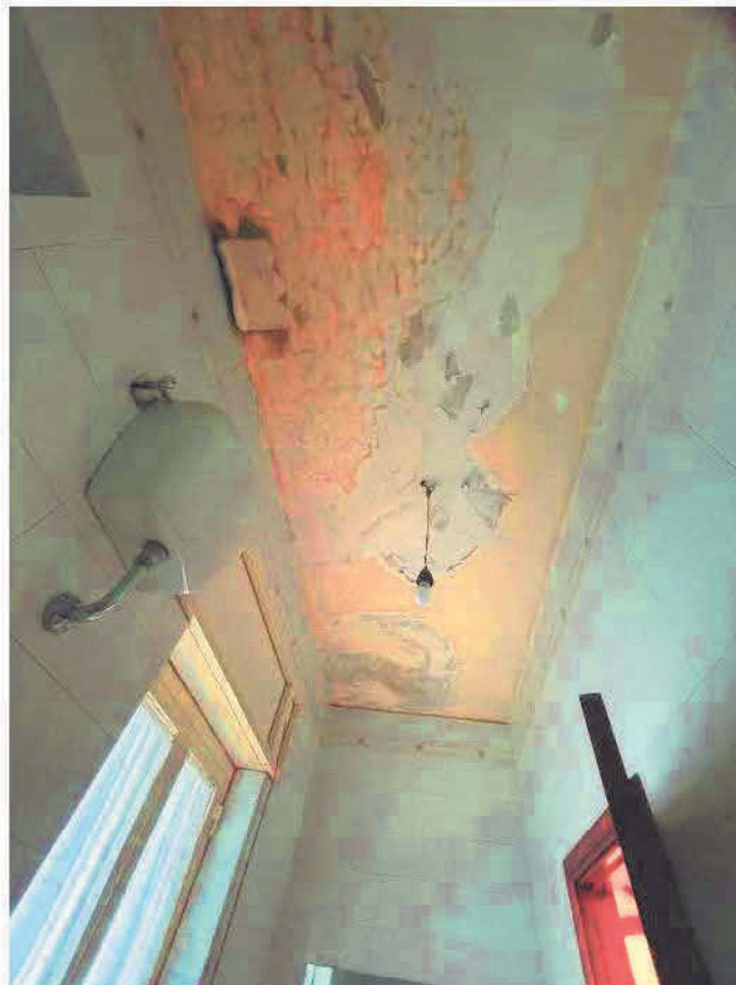
Foto 20 - Vista interna: soffitto w.c.
