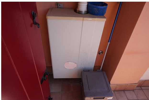
Piano Primo – Caldaia su loggia
