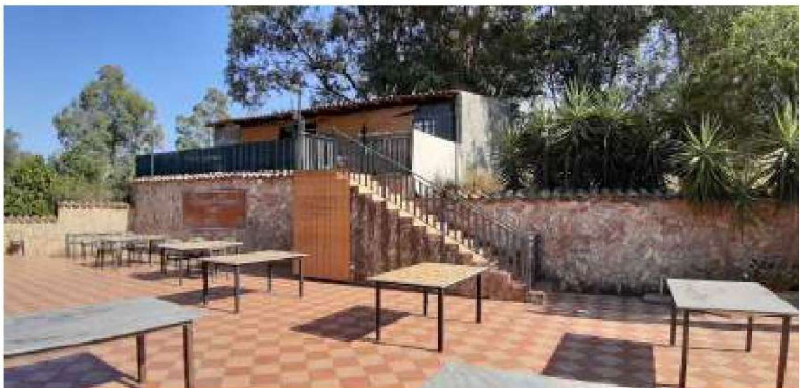
Foto 42: Terrazzo vista Sud-Est, scala per accedere a tettoia abusiva su terreno part.
