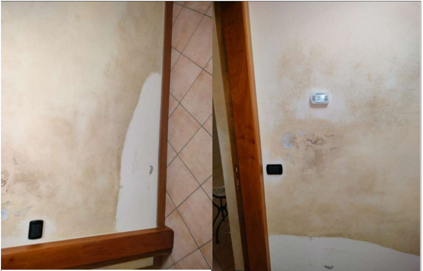
DEGRADO PARETI INTERNE
