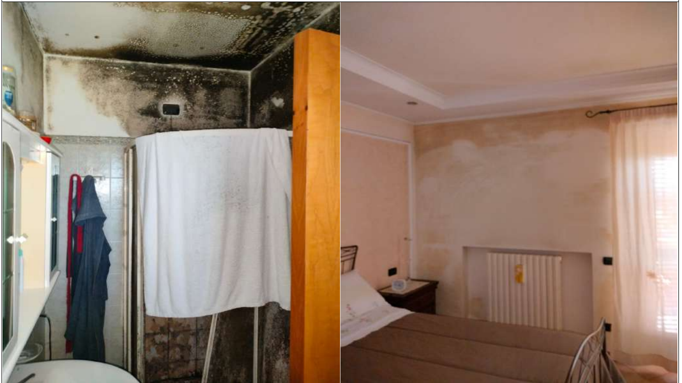
DEGRADO PARETI INTERNE
