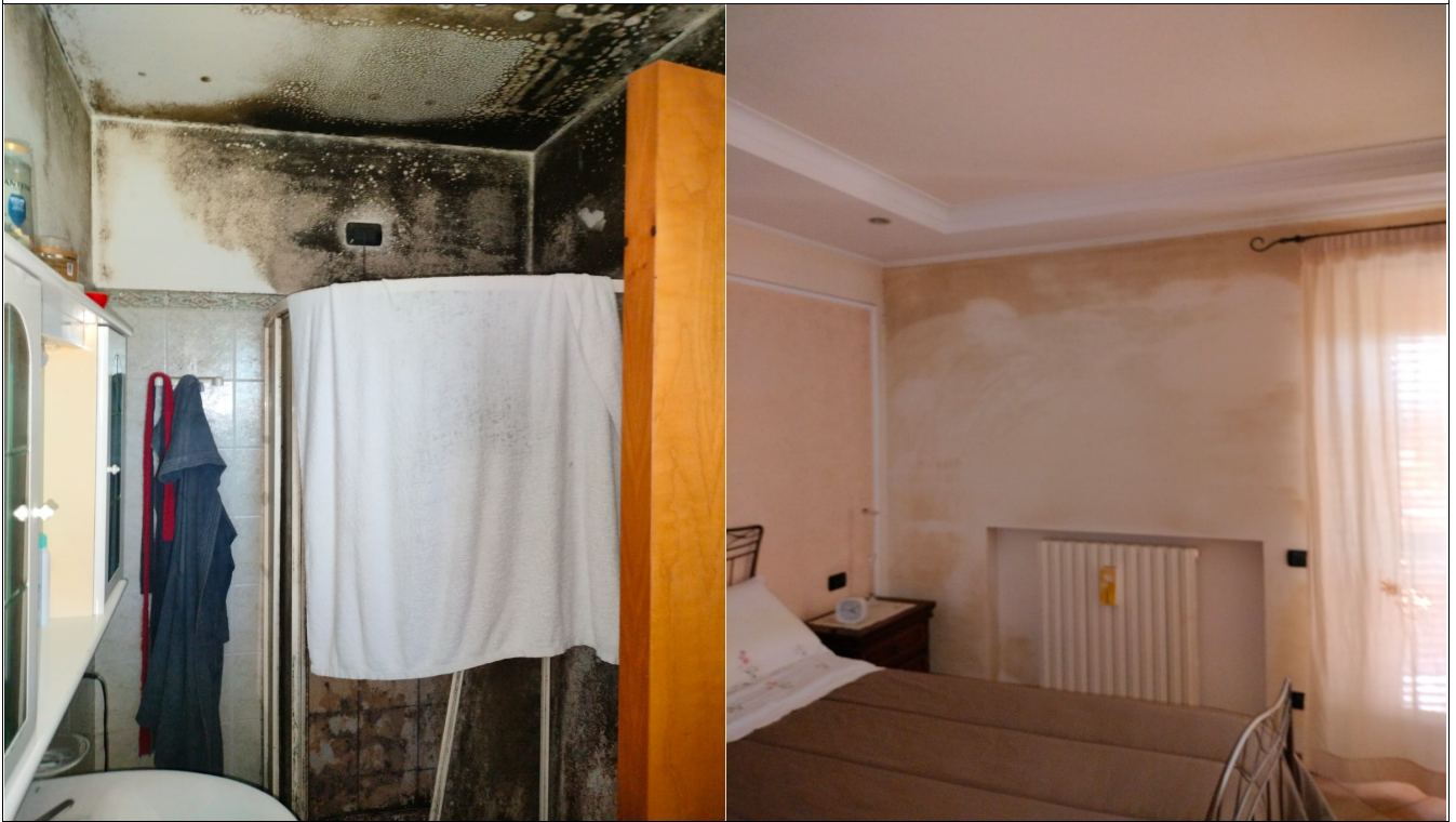
DEGRADO PARETI INTERNE
