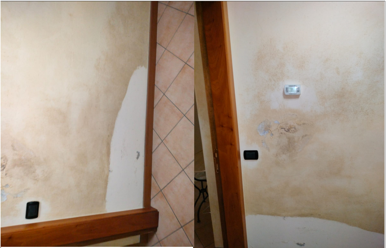
DEGRADO PARETI INTERNE
