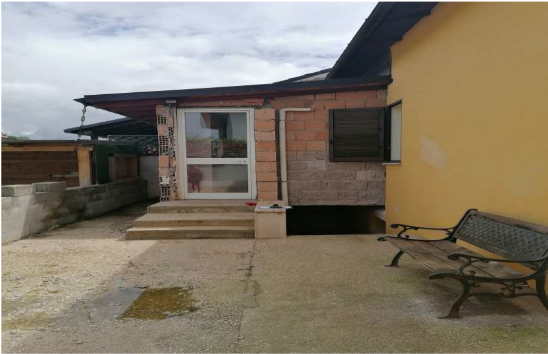
foto n° 3 “porzione di immobile sub.3 al piano T realizzato in difformità”
