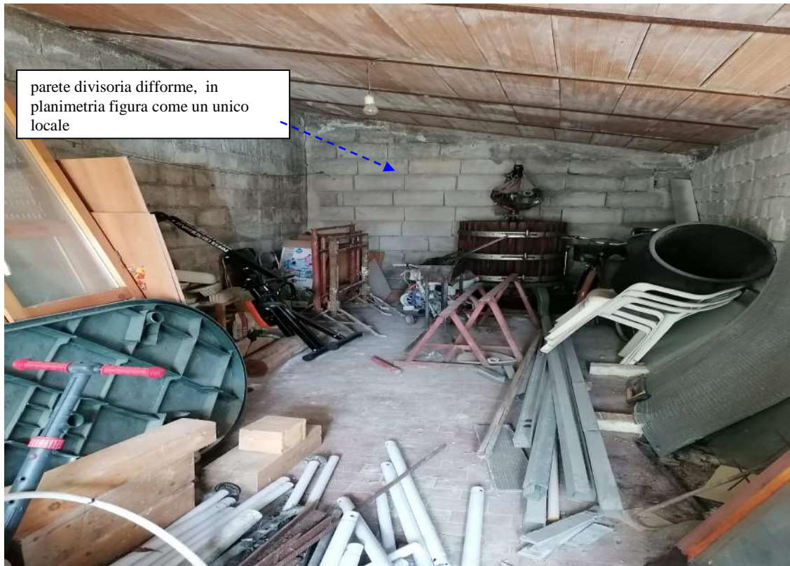
foto n° 13 “garage sub2, in evidenza la parete di separazione interna in difformità ”
