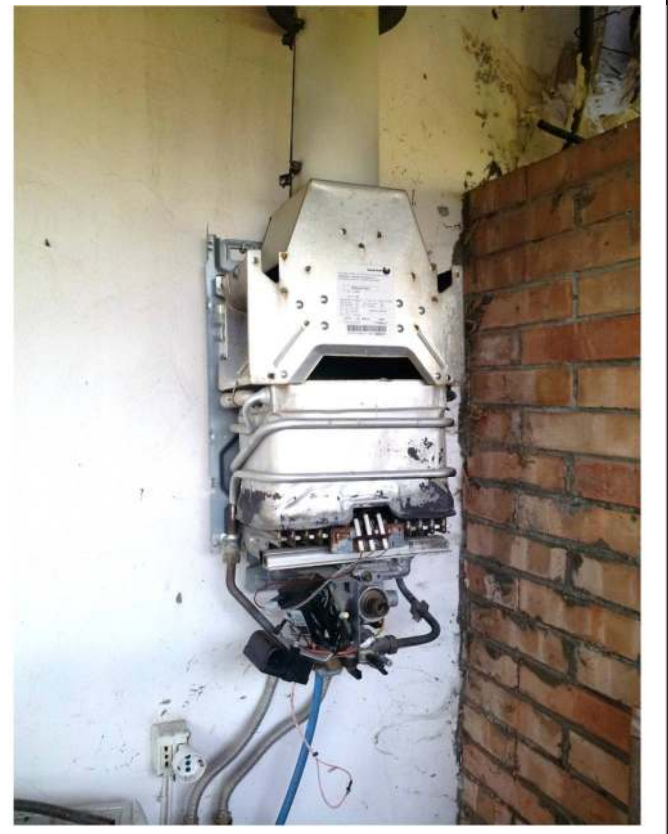
CALDAIA DI ALIMENTAZIONE DELL'IMPIANTO AUTONOMO IN CORSO DI RIPARAZIONE
