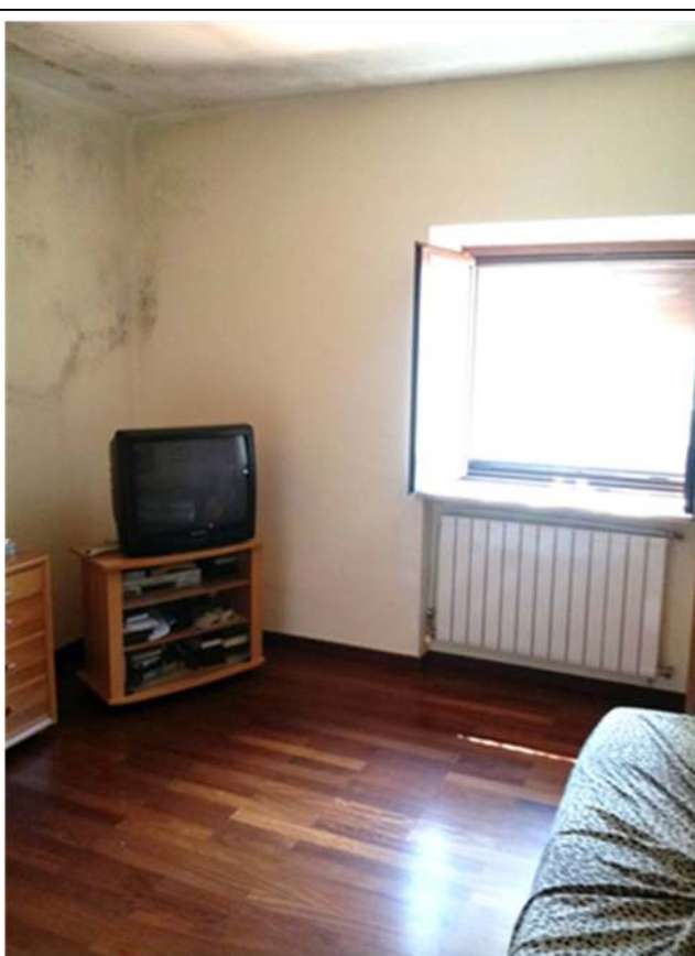
INFILTRAZIONI CAMERA DA LETTO PROVENIENTI DA PERDITE IN COPERTURA
