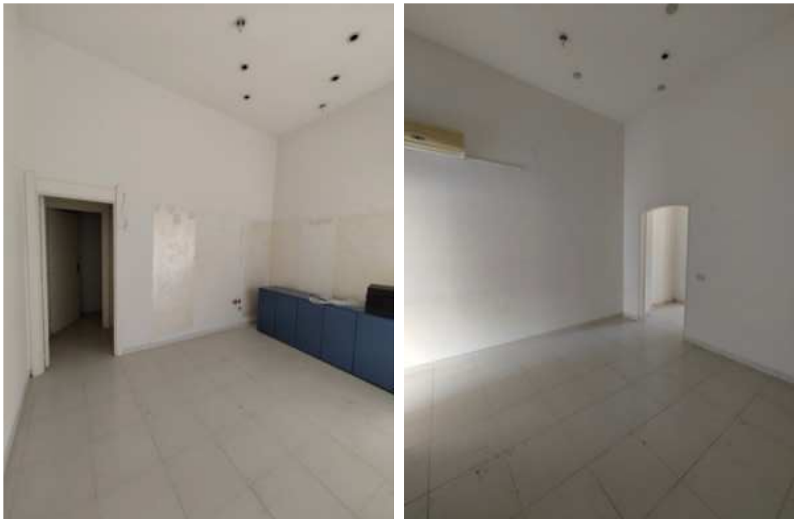
Figg.8-9 – Vano senza affacci all'esterno e privo di aereoilluminazione collegato al bagno
