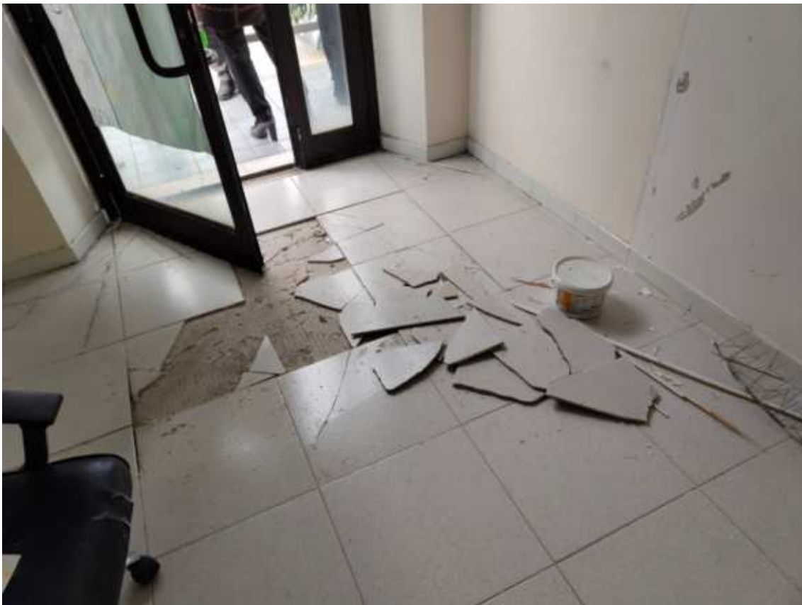
Fig.6 – Vista di dettaglio sulla decoesione delle piastrelle posate in prossimità del varco di accesso
