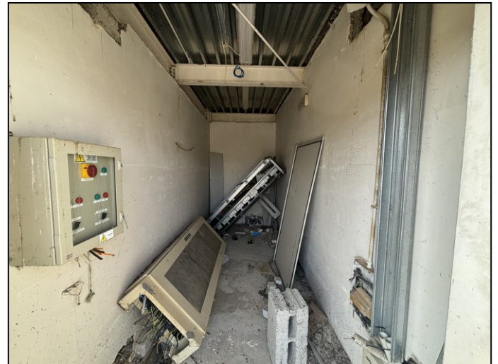
Zona ricevimento e servizi: locale quadri elettrici
