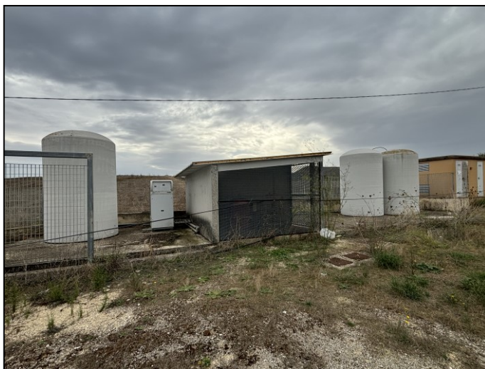
Veduta del volume tecnico, dei serbatoi idrici e del refrigeratore
