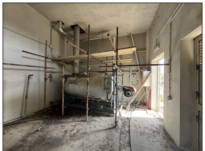
Zona produzione: centrale termica
