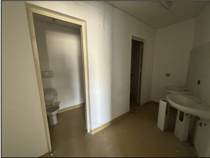
Zona direzionale: servizi igienici
