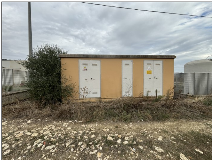
Cabina elettrica MT/BT
