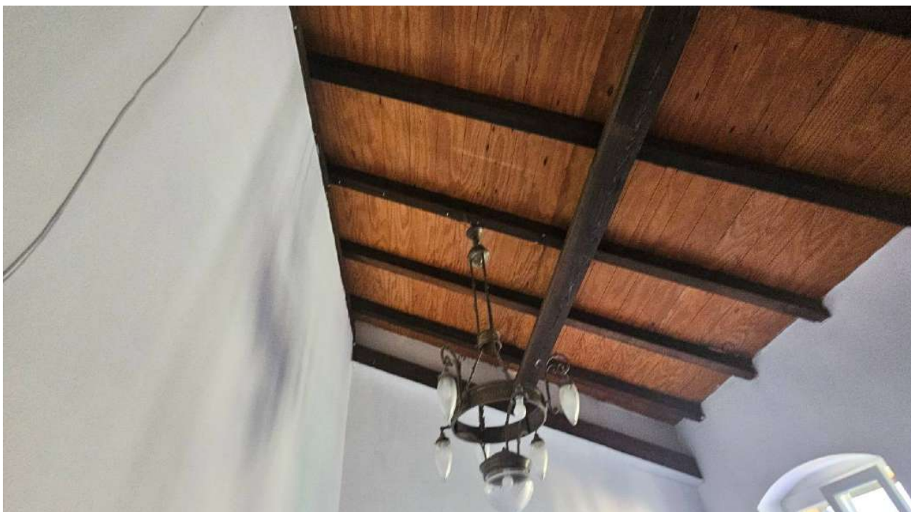
Foto n°11. Particolare soffitto, piano 1°
