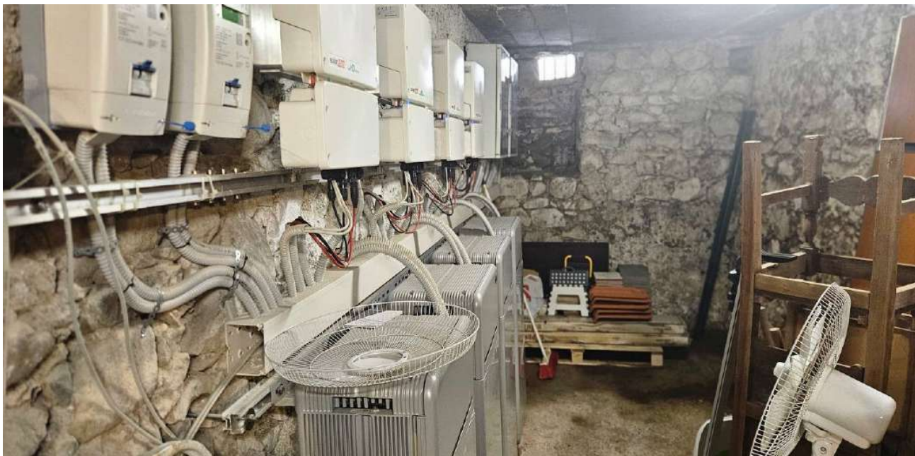
Foto n°5. Cantina, piano 1°ss,- accessori impianto fotovoltaico
