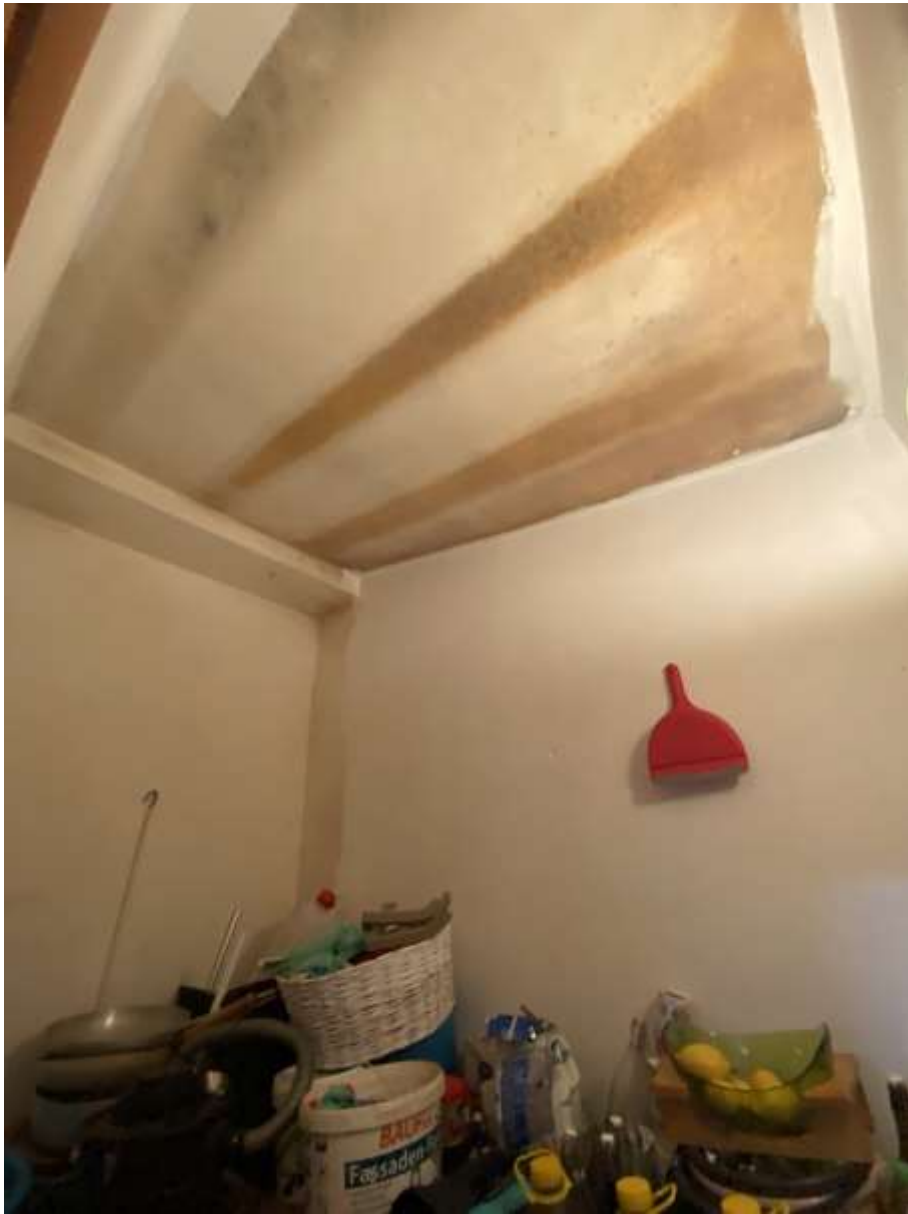
Foto 10.1) – Dettaglio infiltrazioni soffitto ripostiglio ( IMMOBILE A )
