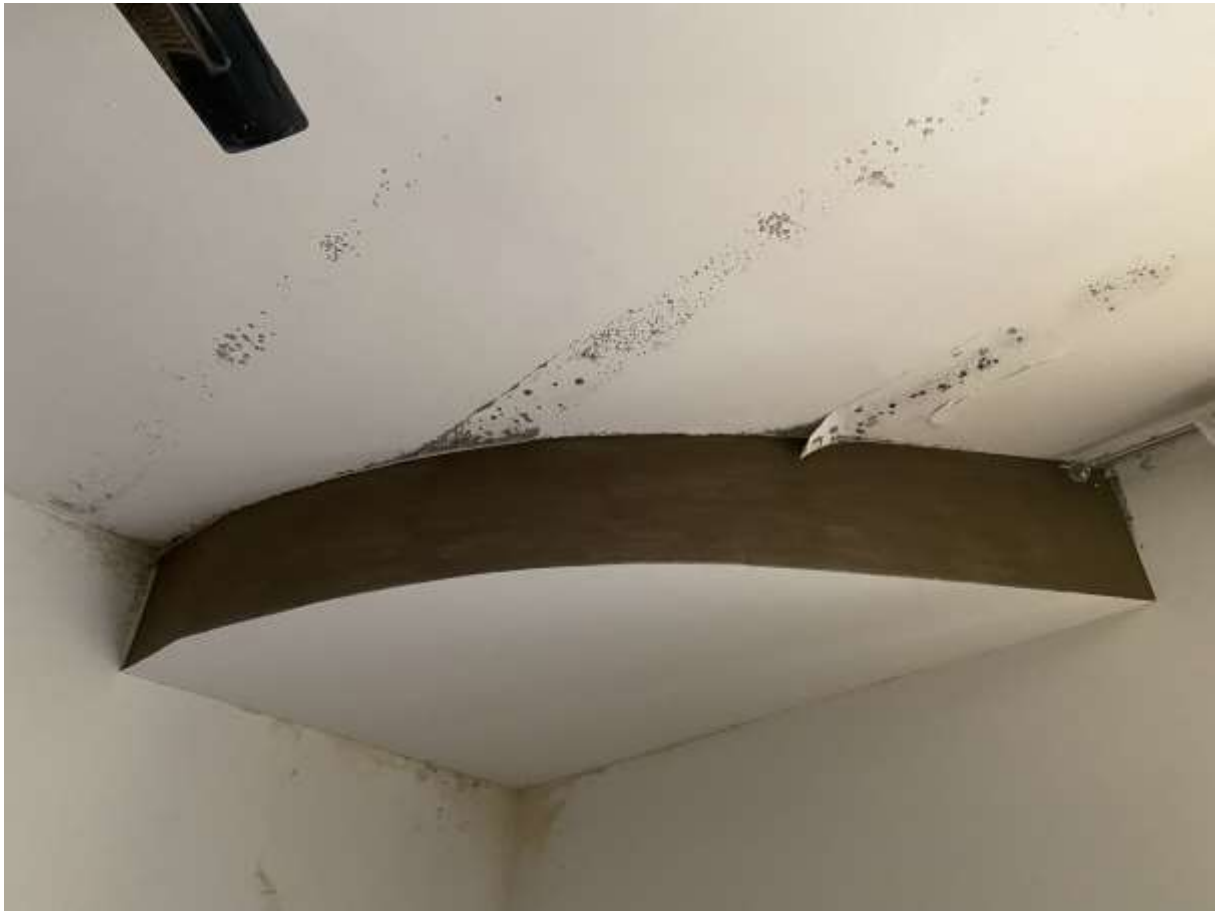
Foto 7) – Dettaglio infiltrazioni soffitto camera da letto ( IMMOBILE A )
