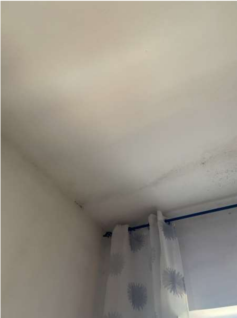
Foto 9.2) – Dettaglio infiltrazioni soffitto cameretta ( IMMOBILE A )
