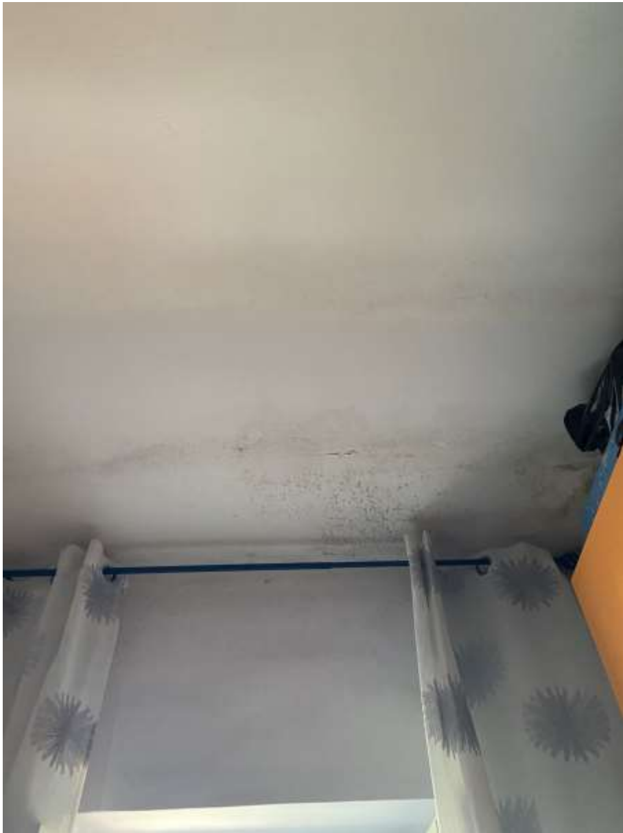
Foto 9.1) – Dettaglio infiltrazioni soffitto cameretta ( IMMOBILE A )
