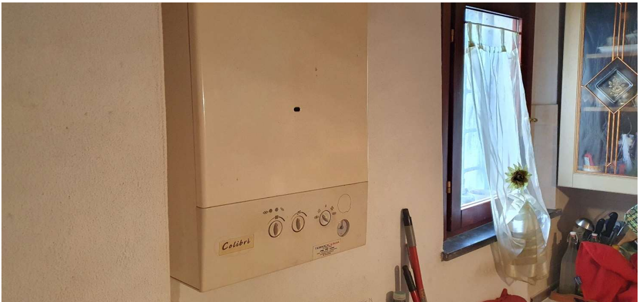
14 CALDAIA CUCINA NON FUNZIONANTE
