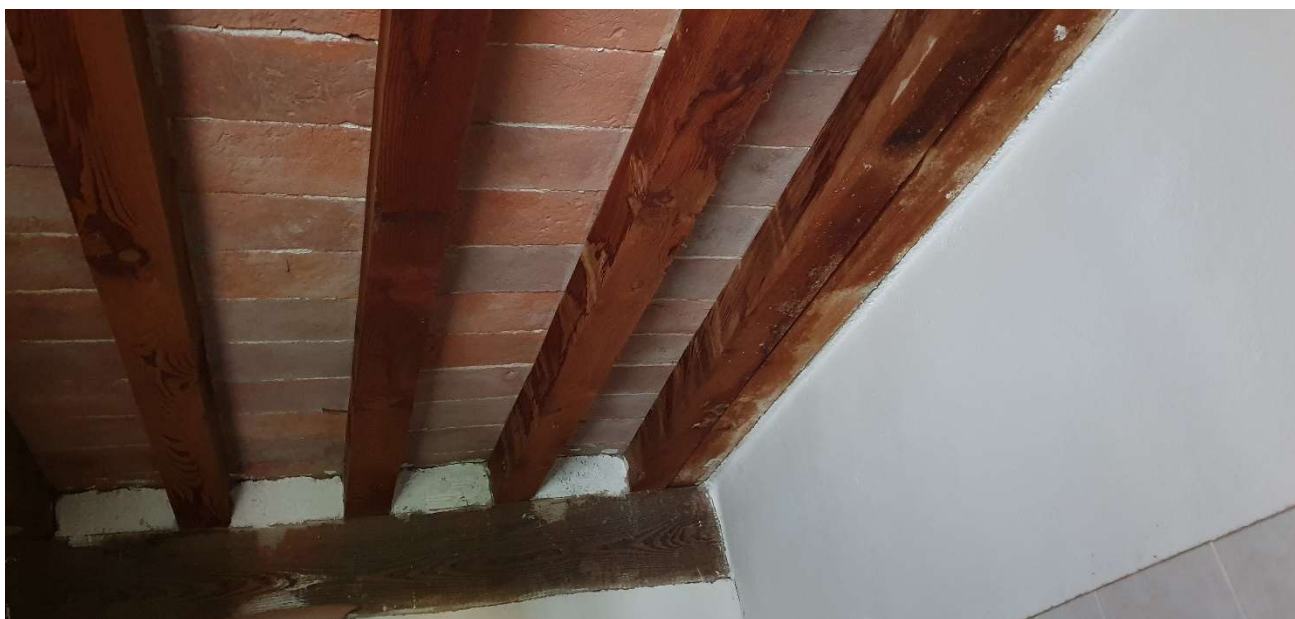
29 PARTICOLARE SOFFITTO BAGNO
