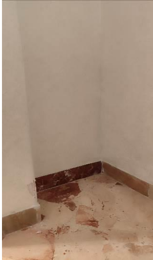
Soggiorno 4 - Umidità di risalita
