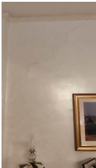
Lesione muratura lato soggiorno 4
