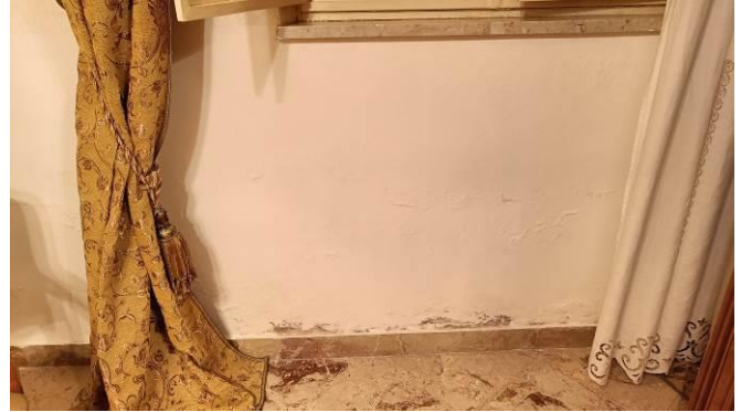
Camera 3 - Umidità di risalita
