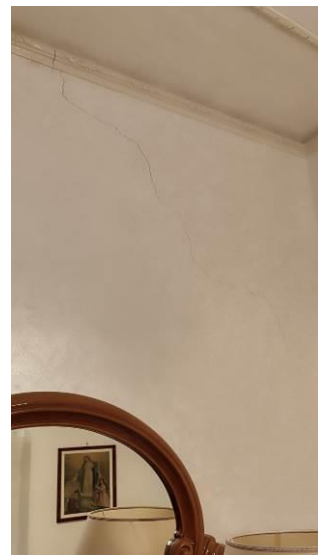
Lesione muratura lato camera 3
