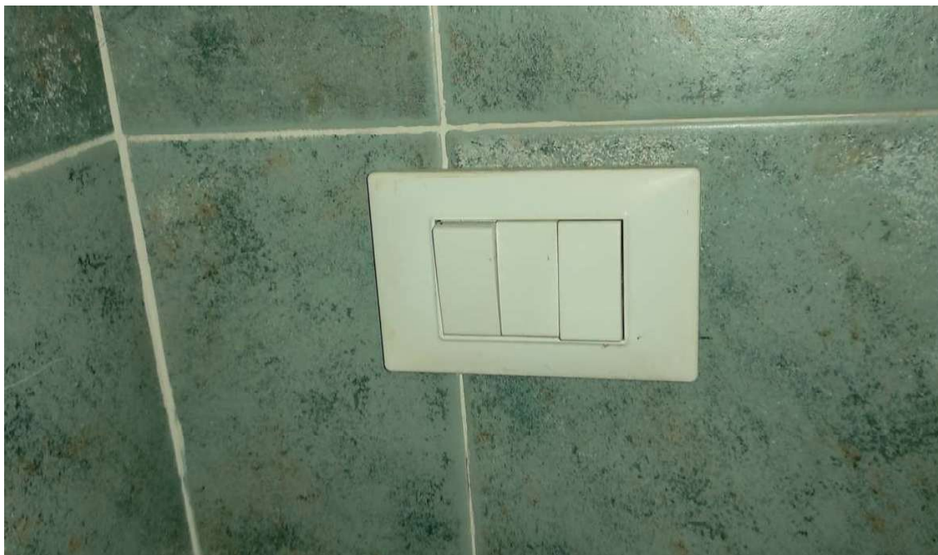
Foto 35 - DETTAGLIO PRESE DI ACCENSIONE IMPIANTO ELETTRICO
