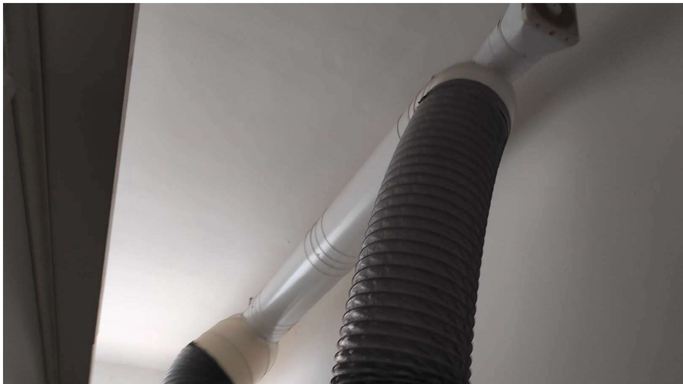
Foto 38 - DETTAGLIO IMPIANTO DI ESTRAZIONE ARIA
