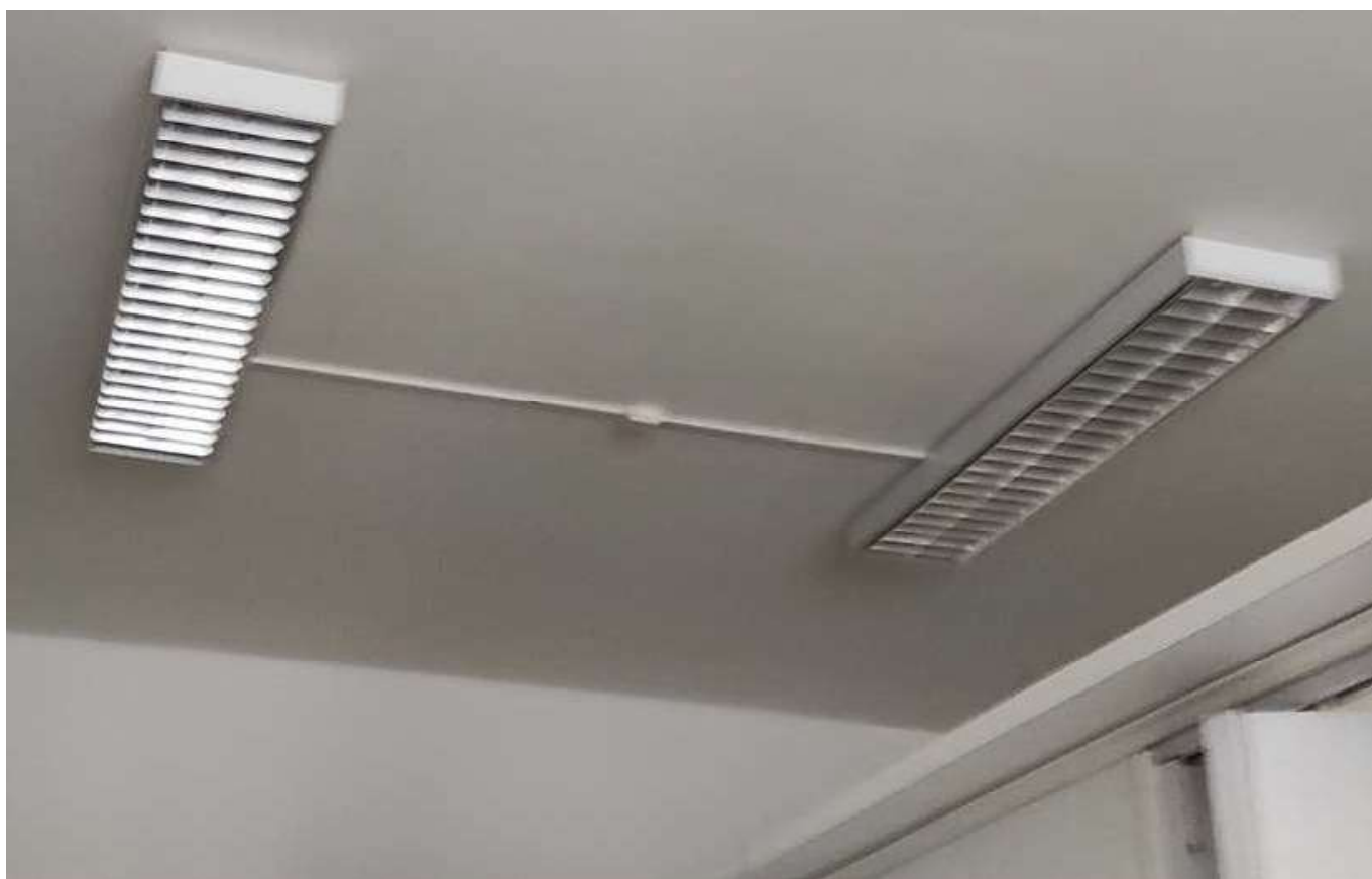
Foto 37 - DETTAGLIO IMPIANTO DI ILLUMINAZIONE A NEON A SOFFITTO
