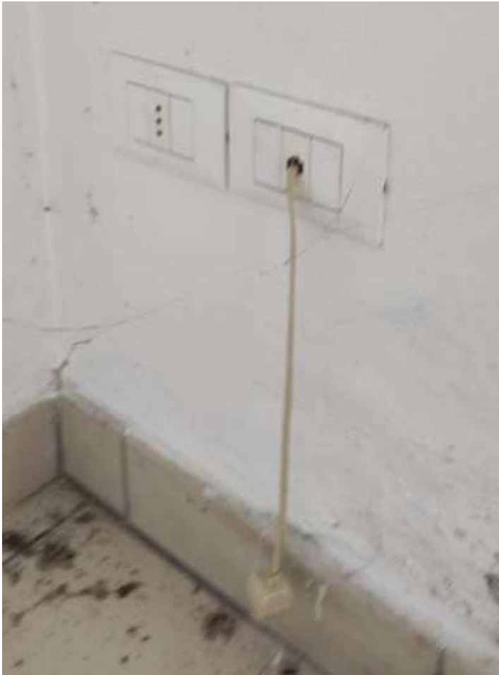
Foto 47 - DETTAGLIO IMPIANTO RETE DATI
