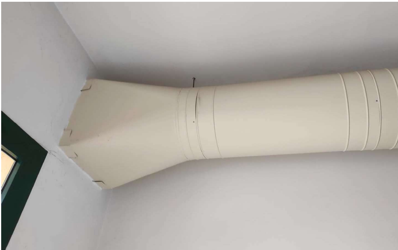
Foto 40 - DETTAGLIO IMPIANTO CANALE DI ESTRAZIONE ARIA
