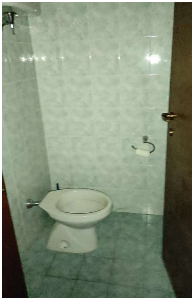
Foto 34 - WC, DETTAGLIO SANITARI
