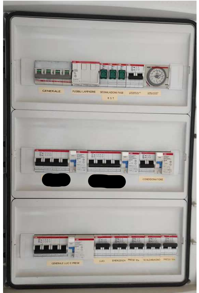
Foto 48 - QUADRO ELETTRICO GENERALE
