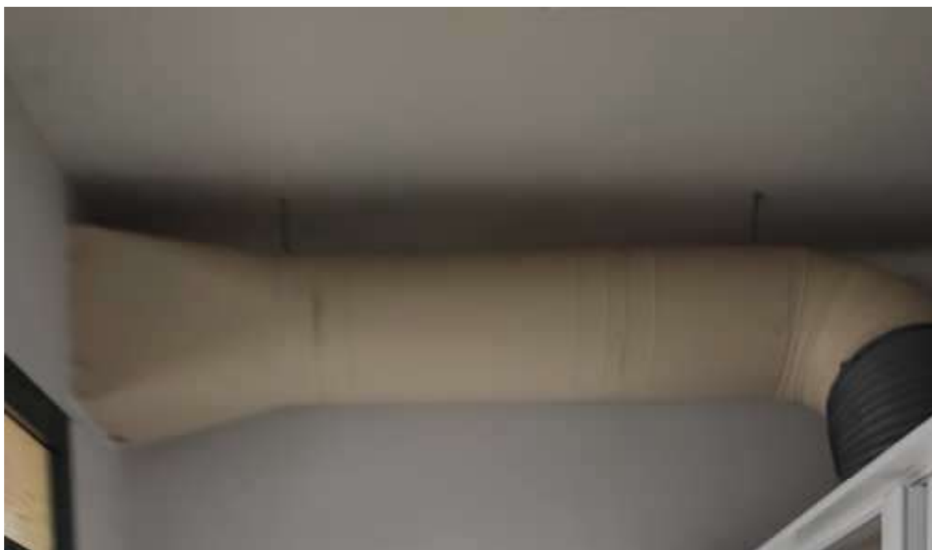
Foto 39 - DETTAGLIO IMPIANTO CANALE DI ESTRAZIONE ARIA
