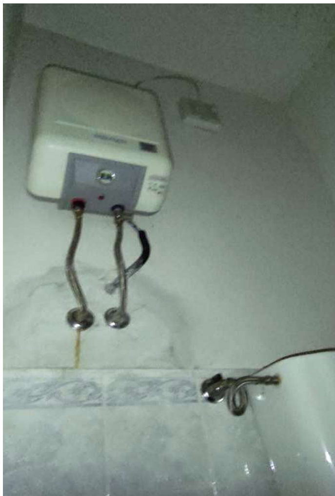
Foto 33 - WC, DETTAGLIO SANITARI E BOILER ELETTRICO
