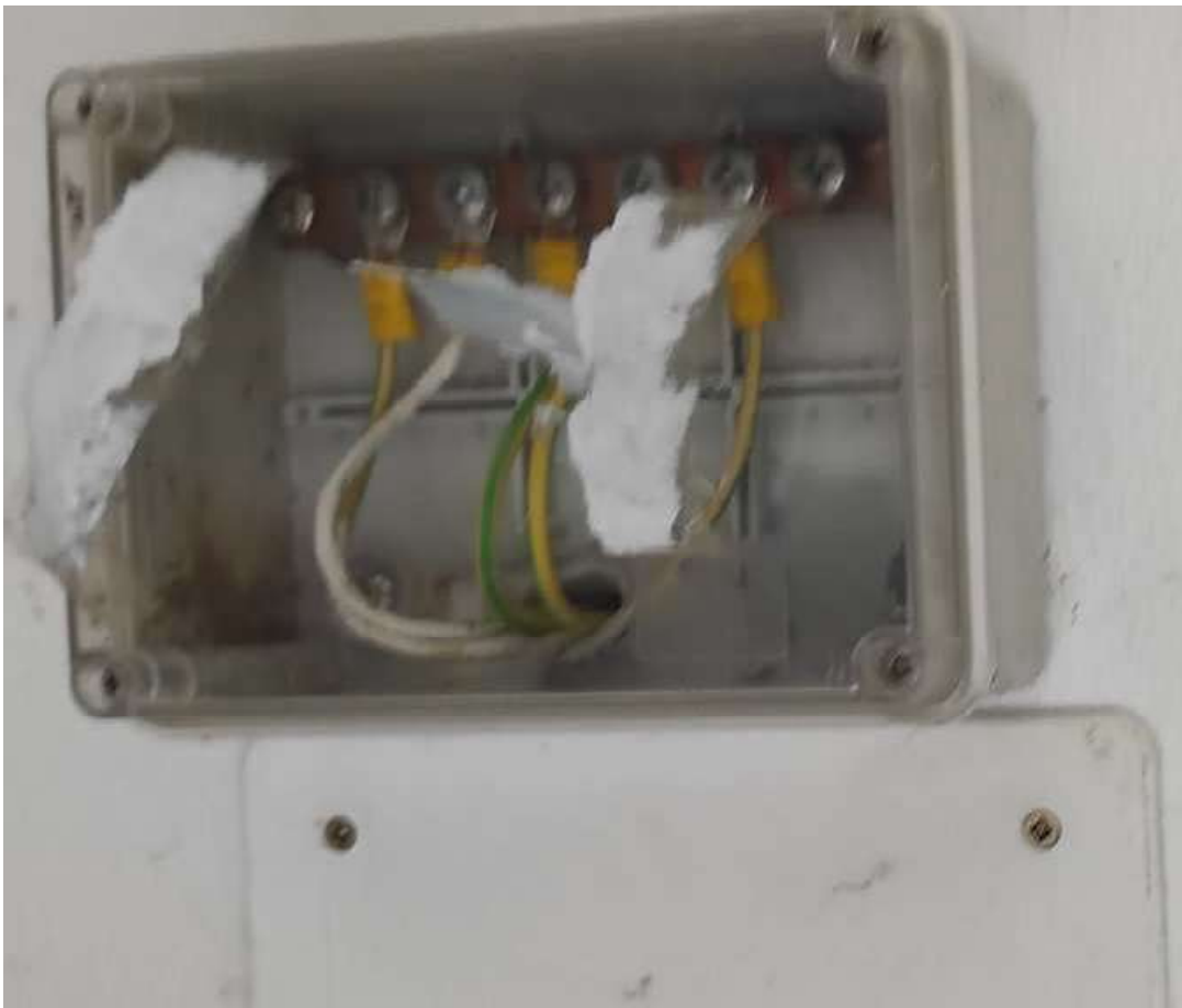
Foto 49 - DETTAGLIO IMPIANTO ELETTRICO
