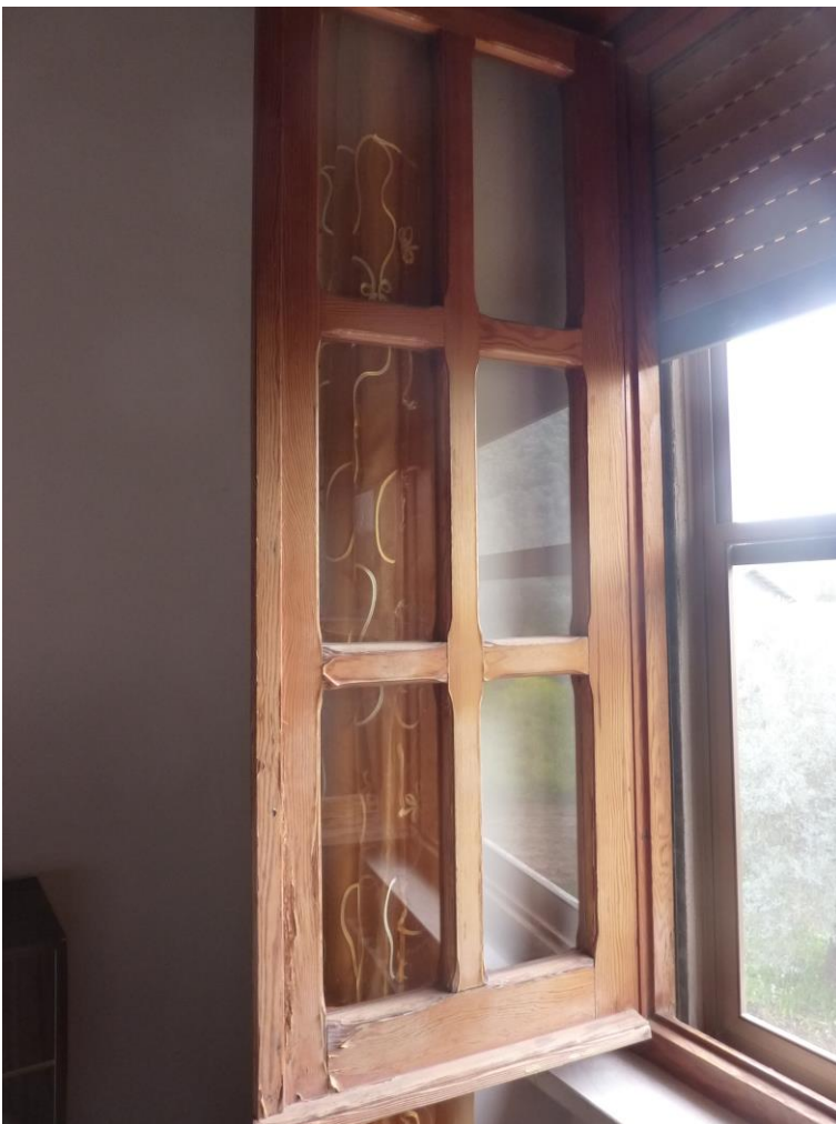
Foto 28 – Infissi in legno, finestra
