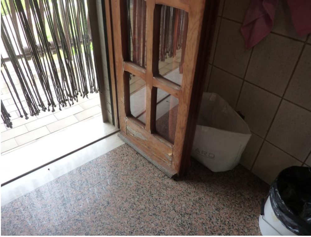
Foto 29 – Infissi in legno, portafinestra
