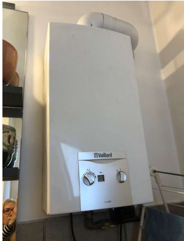
Caldaia acqua calda
