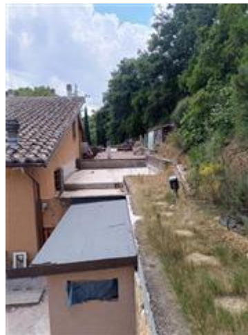
LOCALE REALIZZATO SENZA TITOLO EDILIZIO -- COPERTURA
