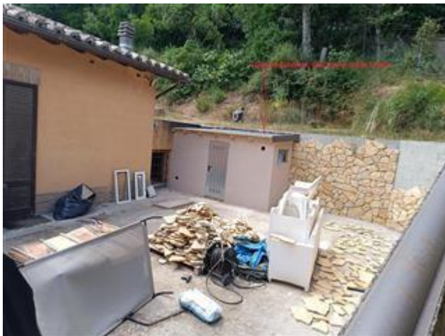
LOCALE REALIZZATO SENZA TITOLO EDILIZIO - PROSPETTO
