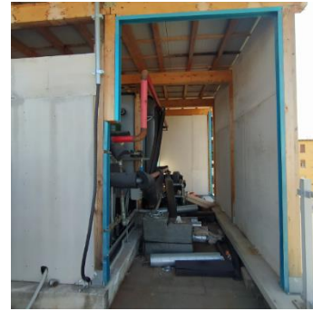
Interno locale impianti in copertura
