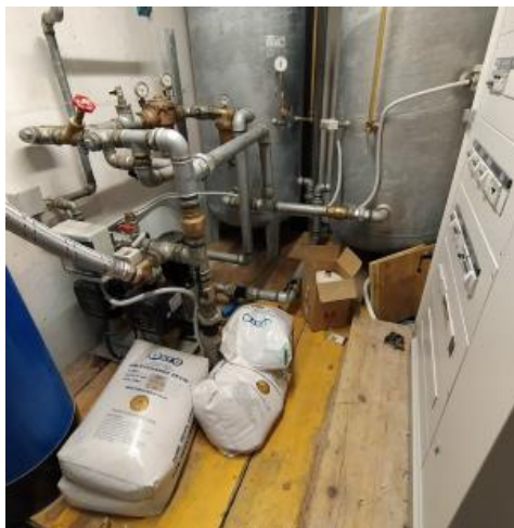
Locale impianti piano terra
