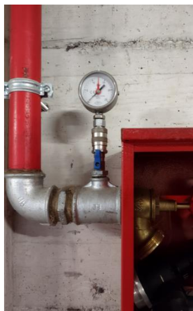
Impianto antincendio non in pressione
