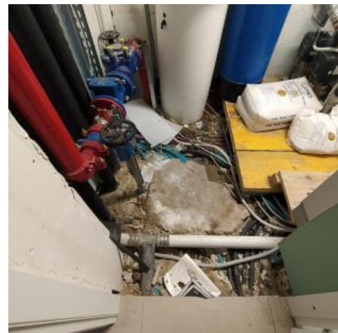
Locali impianti piano terra
