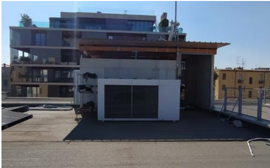
Locale impianti in copertura
