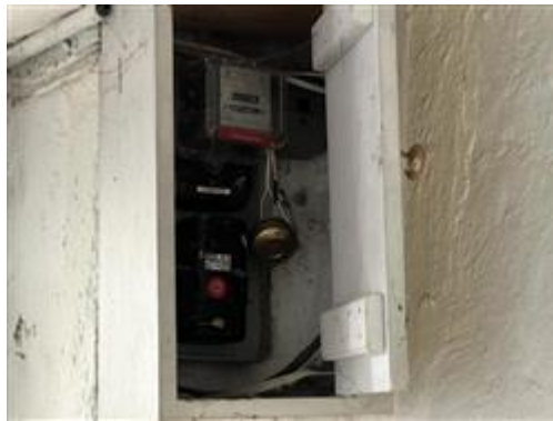
vista contatore elettrico
