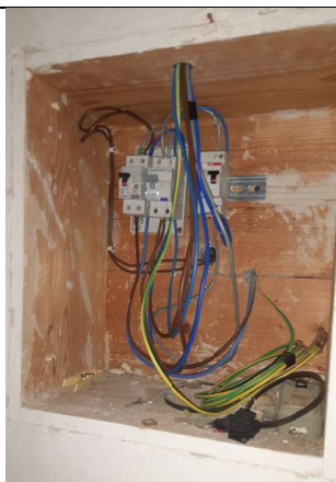
Interruttori impianto elettrico
