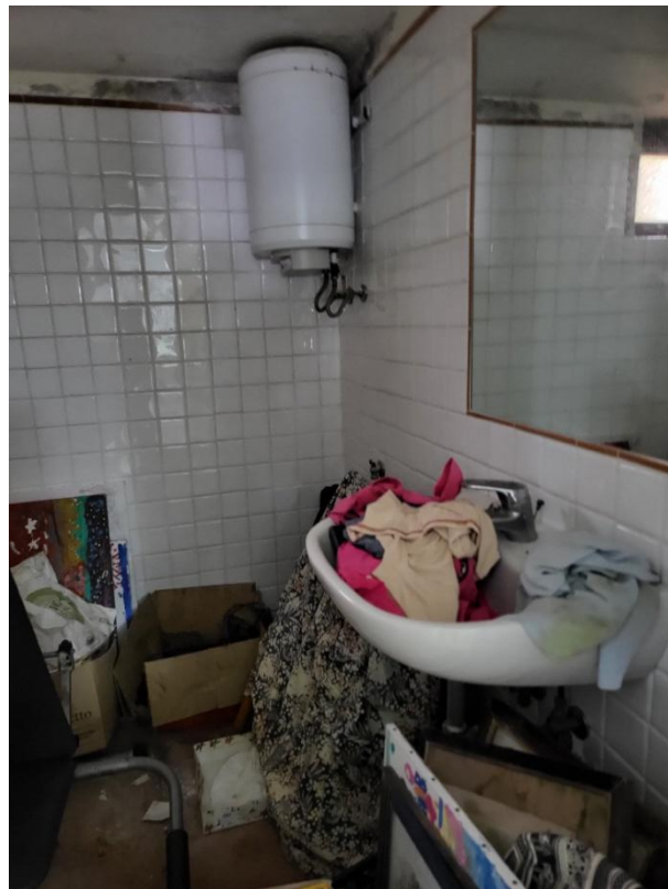
Foto 7 – Bagno abusivo ubicato all'interno del magazzino seminterrato identificato al sub 7
