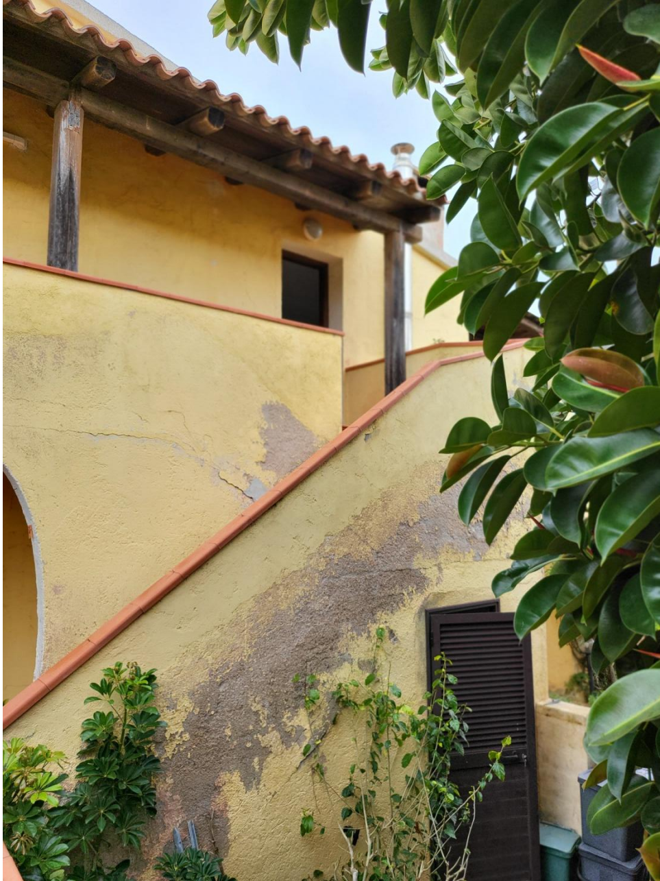
Foto 17 – Scala di accesso all'appartamento piano primo identificato al sub 6 su via Vespucci (In evidenza locale sottoscala chiuso abusivamente)
