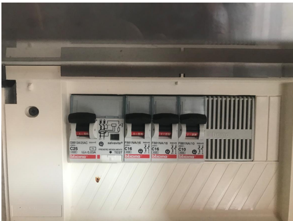
Foto 28 - Quadro elettrico piano terra
