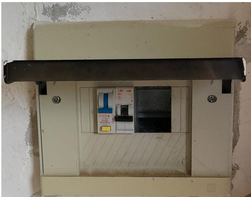
Foto 19 – Quadro elettrico locale cantina
