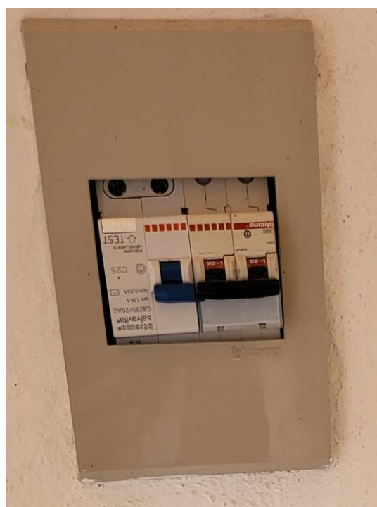
Foto 11 – Quadro elettrico ubicato al piano terra
