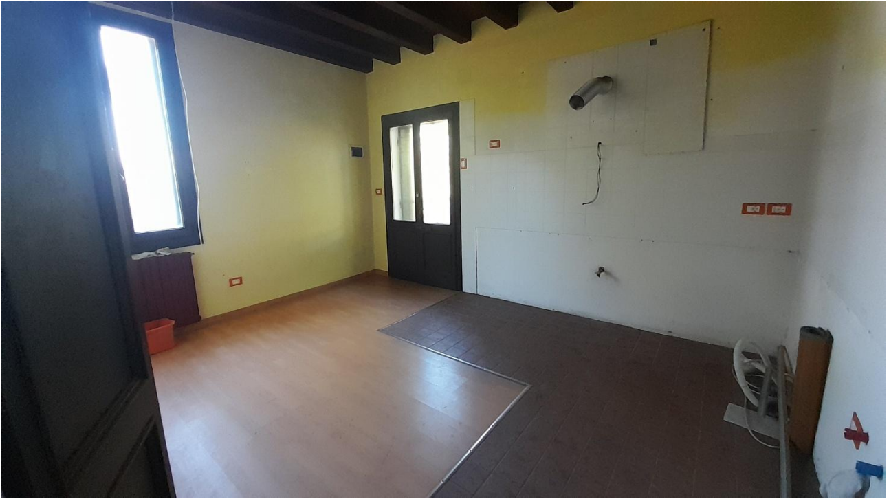
FOTO 30 – STANZA ADIBITA A CUCINA AL PIANO PRIMO
