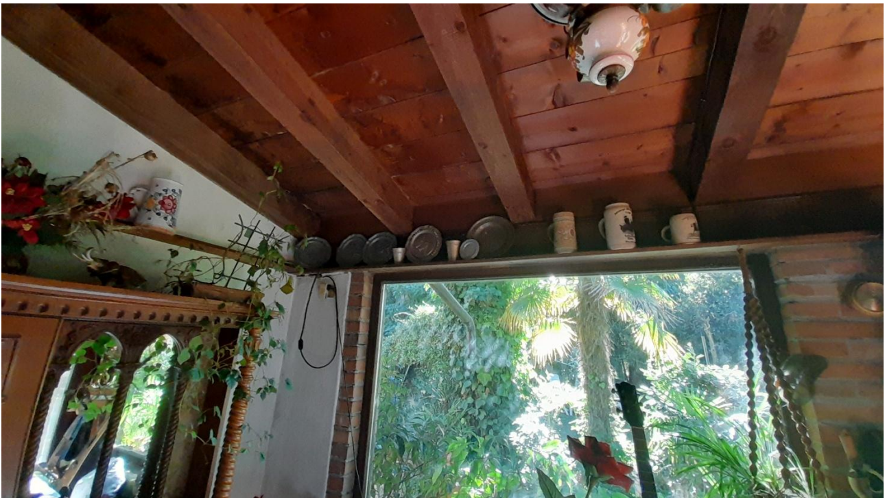
FOTO 17 – INFILTRAZIONI SOFFITTO VERANDA
