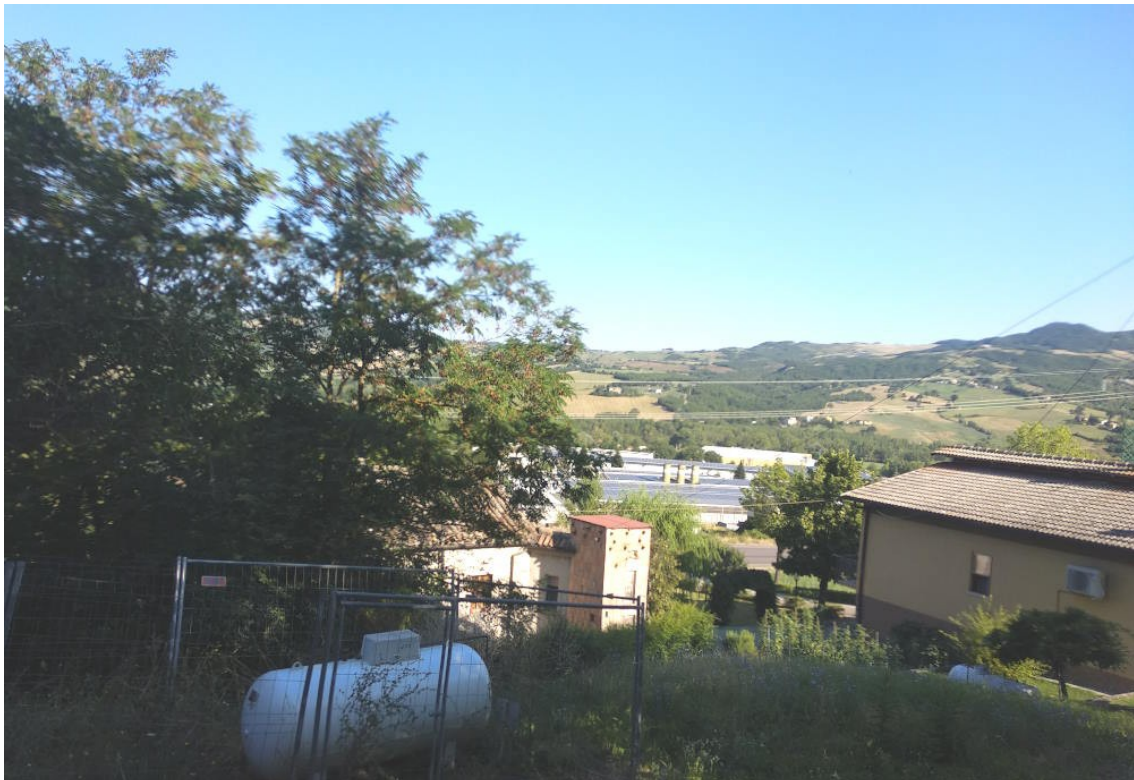
FOTO 23 – corte, dettaglio accumulatore GPL
