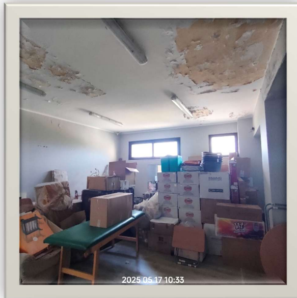
Foto n. 6 : danni da infiltrazioni di acqua riscontrati all'interno dell'u.i.u. pignorata.
