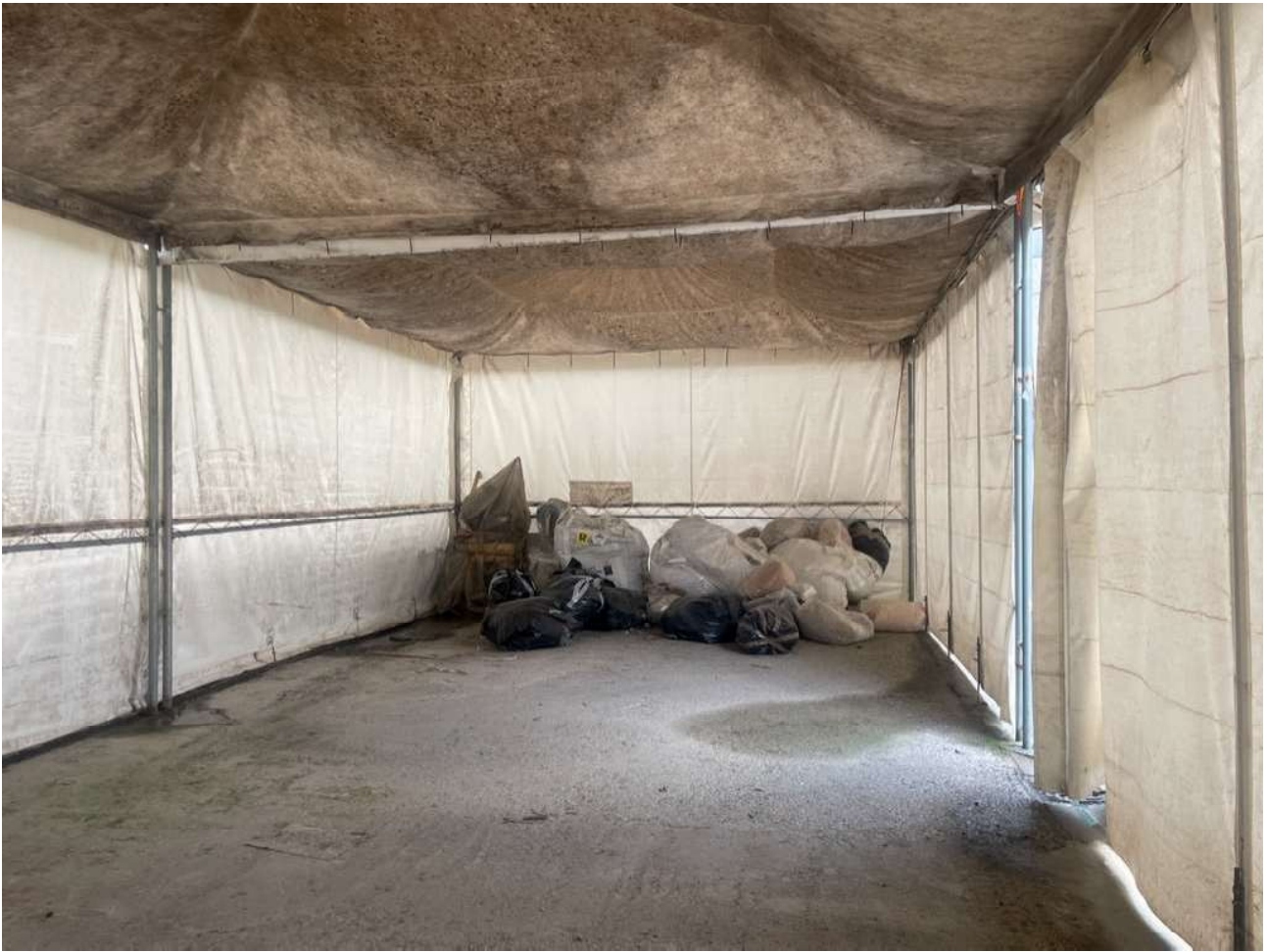
Foto 9 – Struttura precaria su piazzale comune
