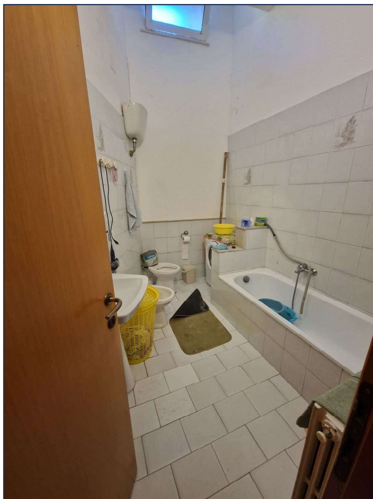
Foto 19: bagno (interdetto accesso con nastro segnaletico da squadra Vigili del Fuoco per lesioni esterne ed interne a porzione di fabbricato)
