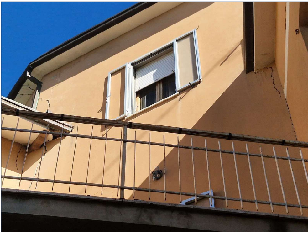
Foto 14: prospetto sud (lesioni strutturali)
