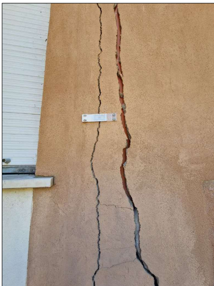
Foto 6: prospetto nord (lesioni strutturali)
