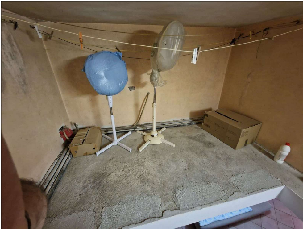
Foto 29: piano ammezzato (porzione sopra a vano "disimpegno") - (interdetto accesso con nastro segnaletico da squadra Vigili del Fuoco per lesioni esterne ed interne a porzione del fabbricato)
