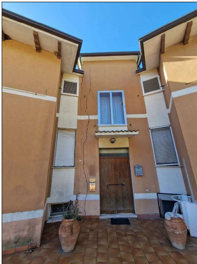
Foto 5: prospetto nord (ingresso a vano scala condominiale e lesioni strutturali)
