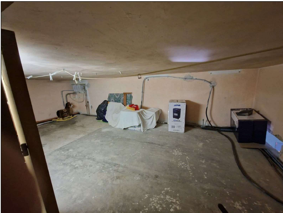
Foto 30: piano ammezzato (porzione sopra a vano "disimpegno", "camera 1" e "corridoio zona notte") - (interdetto accesso con nastro segnaletico da squadra Vigili del Fuoco per lesioni esterne ed interne a porzione del fabbricato)
