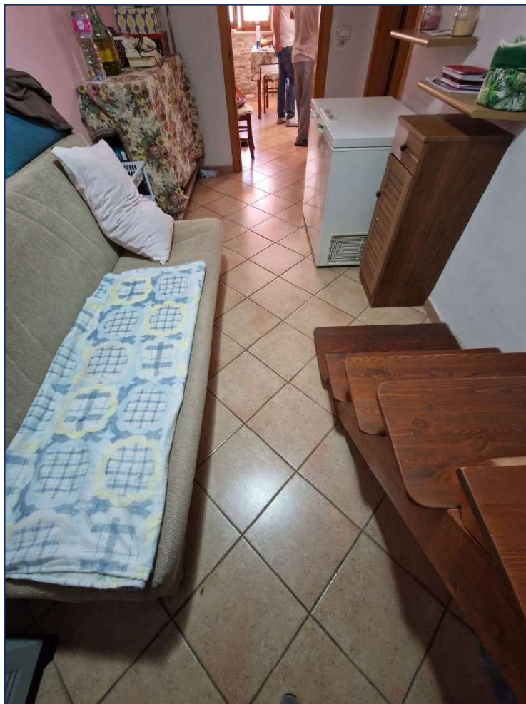
Foto 18: disimpegno (interdetto accesso a vano scale condominiale, bagno e piano ammezzato con nastro segnaletico da squadra Vigili del Fuoco per lesioni esterne ed interne a porzione del fabbricato)
