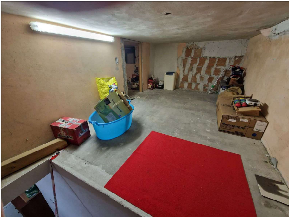
Foto 28: piano ammezzato (porzione sopra a "camera 1") - (interdetto accesso con nastro segnaletico da squadra Vigili del Fuoco per lesioni esterne ed interne a porzione del fabbricato)
