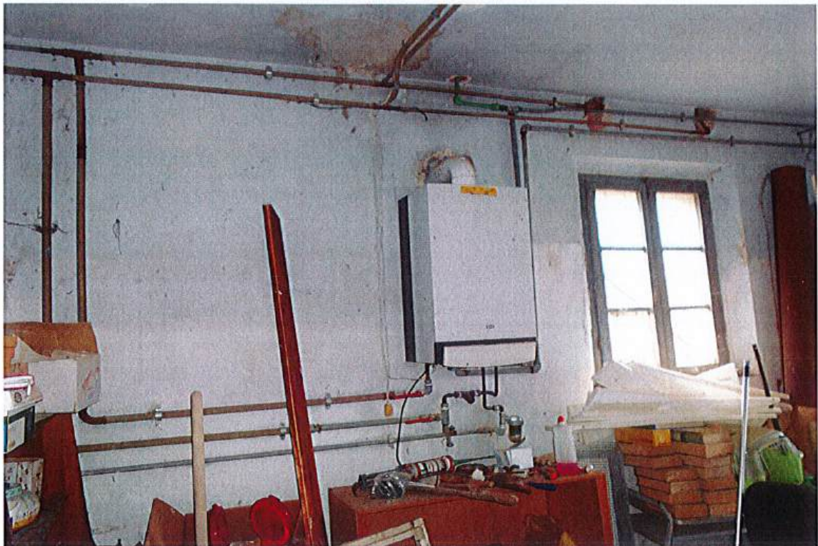
Particolare alloggiamento caldaia e tubazioni esterne acqua e metano
