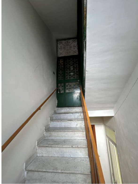
Foto n. 7 – Vano scala del fabbricato al terzo piano verso il ballatoio di accesso all'immobile
