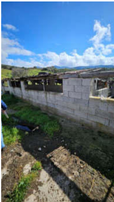
Vista struttura precaria Tettoia ( su mappale 564)
