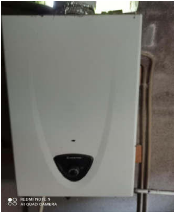
Foto impianto produzione acqua calda sanitaria (caldaia a Gas ubicata in centrale termica)
