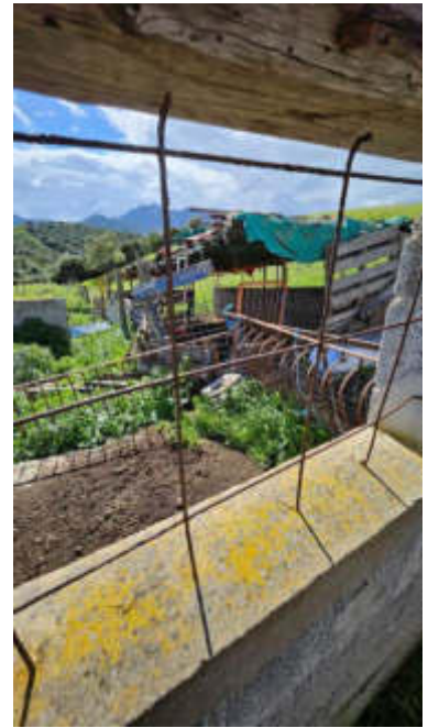
Vista struttura precaria Tettoia ( su mappale 564)
