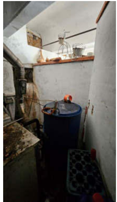
Tettoia alloggiamento impianti
