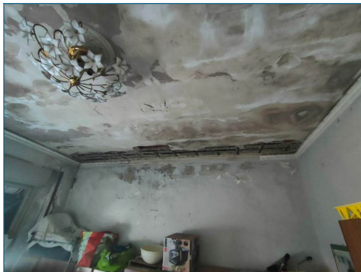
Condizione del soffitto della prima camera
