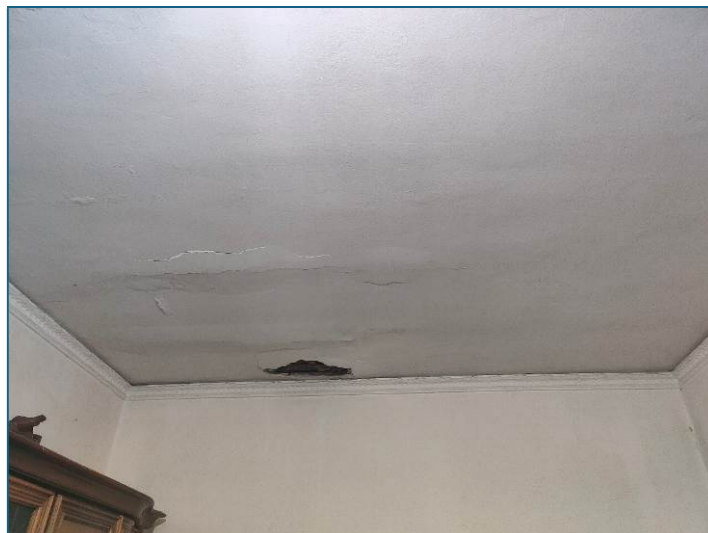
Condizione del soffitto della terza camera
