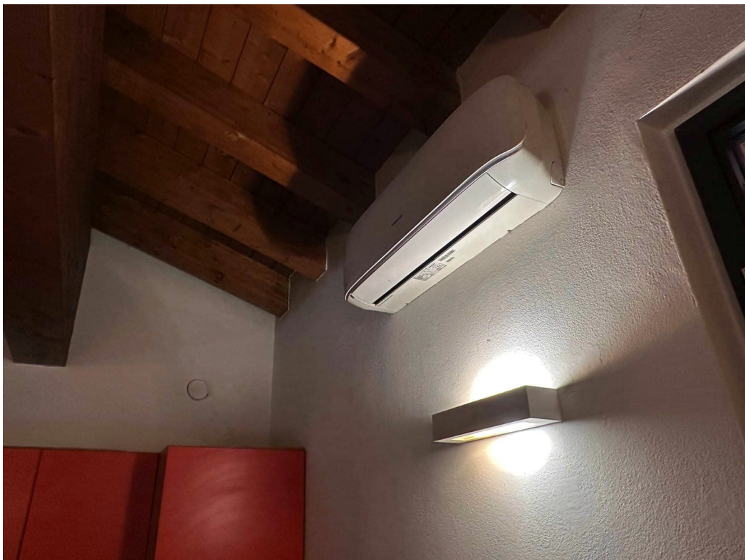
Foto 23 - Impianto di condizionamento
