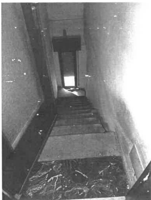
STATO DI FATTO – finestra scala inesistente
