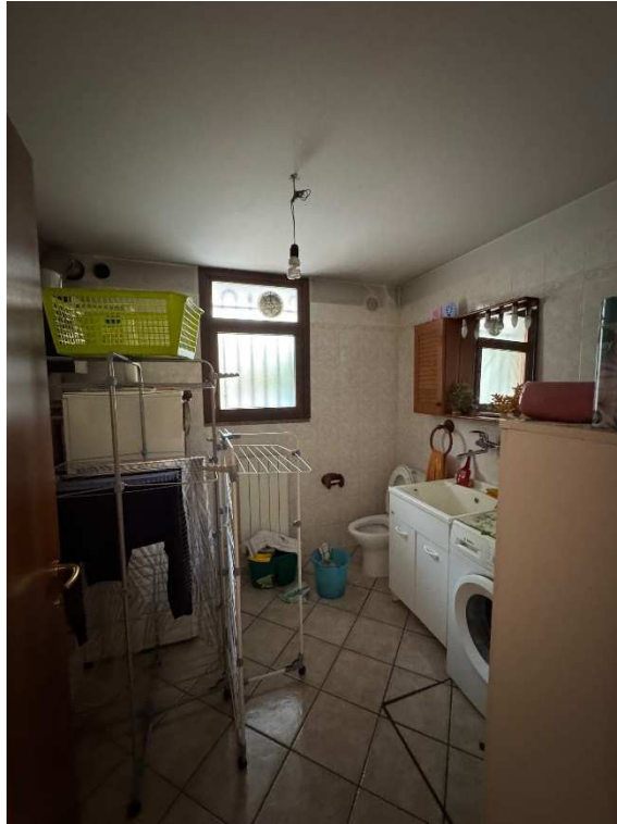
Vista del locale caldaia
