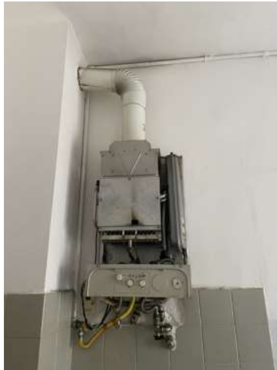
Foto 10: Caldaia posta in cucina.
