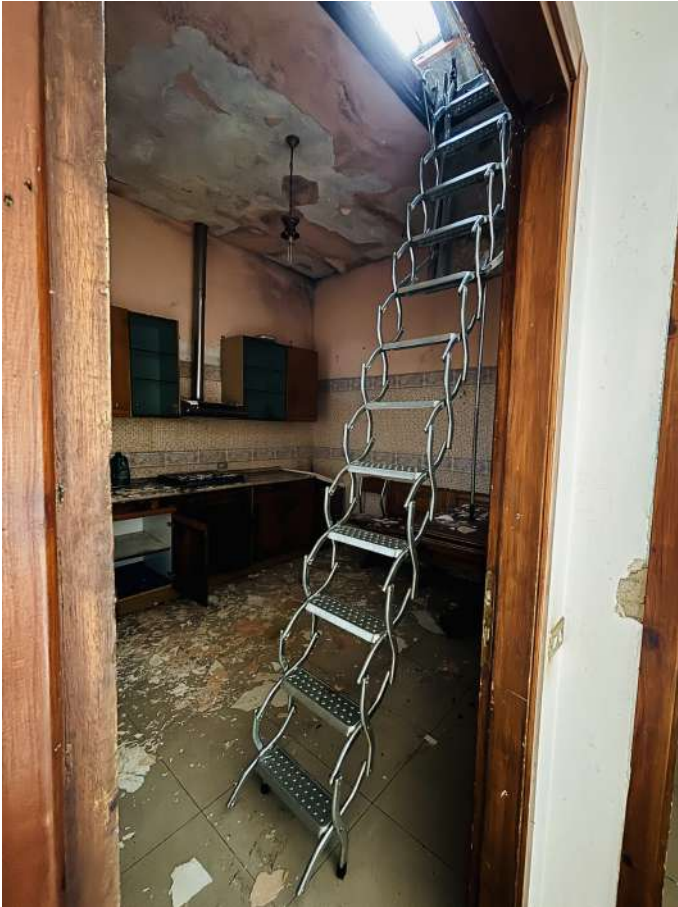
Fotografia 39. Lotto B. Botola di accesso al sottotetto.
