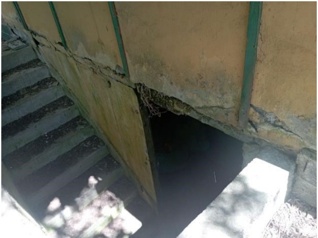
FABBRICATO COLLABENTE - ACCESSO AL SEMINTERRATO
