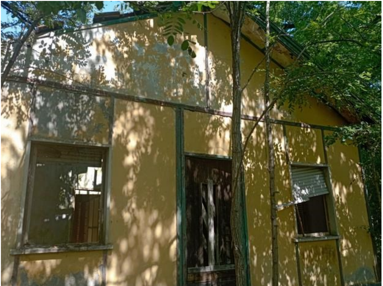
FABBRICATO COLLABENTE - LATO OVEST
