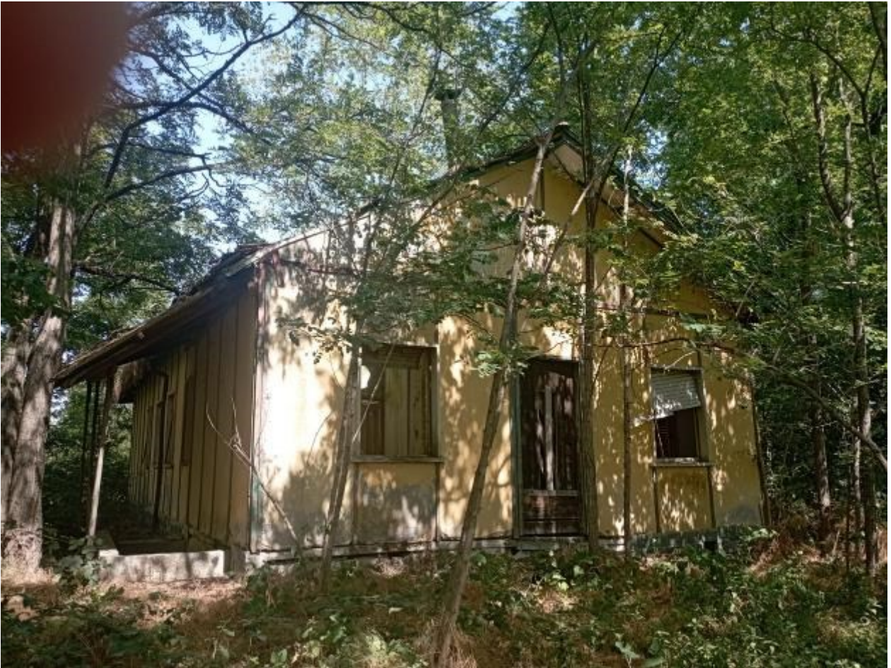
FABBRICATO COLLABENTE - LATO OVEST
