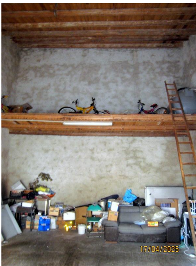
Foto n. 14. Il soppalco in legno. I muri sono pregni di umidità.
