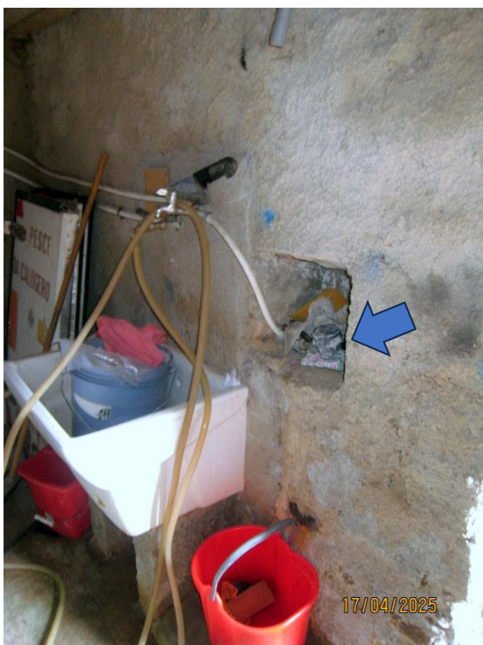
Foto n. 18. Il misuratore idrico.
