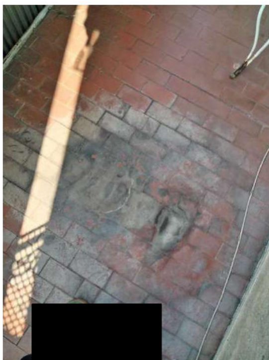
12) Pavimentazione (un po' usurata) del balcone,
