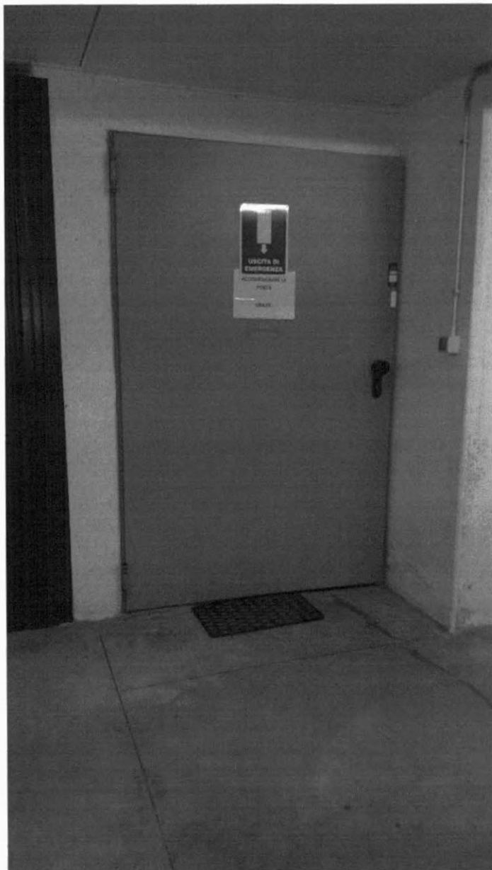
FOTO 16_Porta REI vista dall'autorimessa
