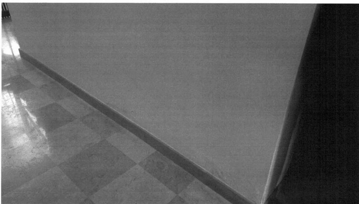
FOTO 27_Piano terra_Vano scala condominiale_Muro unità pignorata Sub 61
