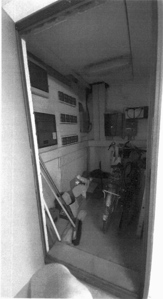
FOTO 23_Piano interrato_Vano contatori
