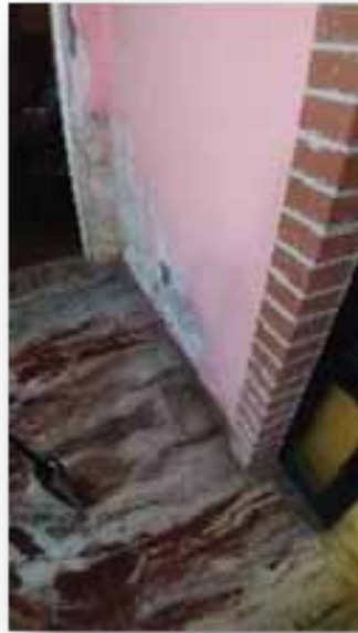
Foto 102 – Umidità di risalita
